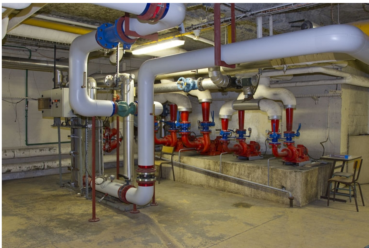
Externat (sous-sol), chaufferie : les pompes.
