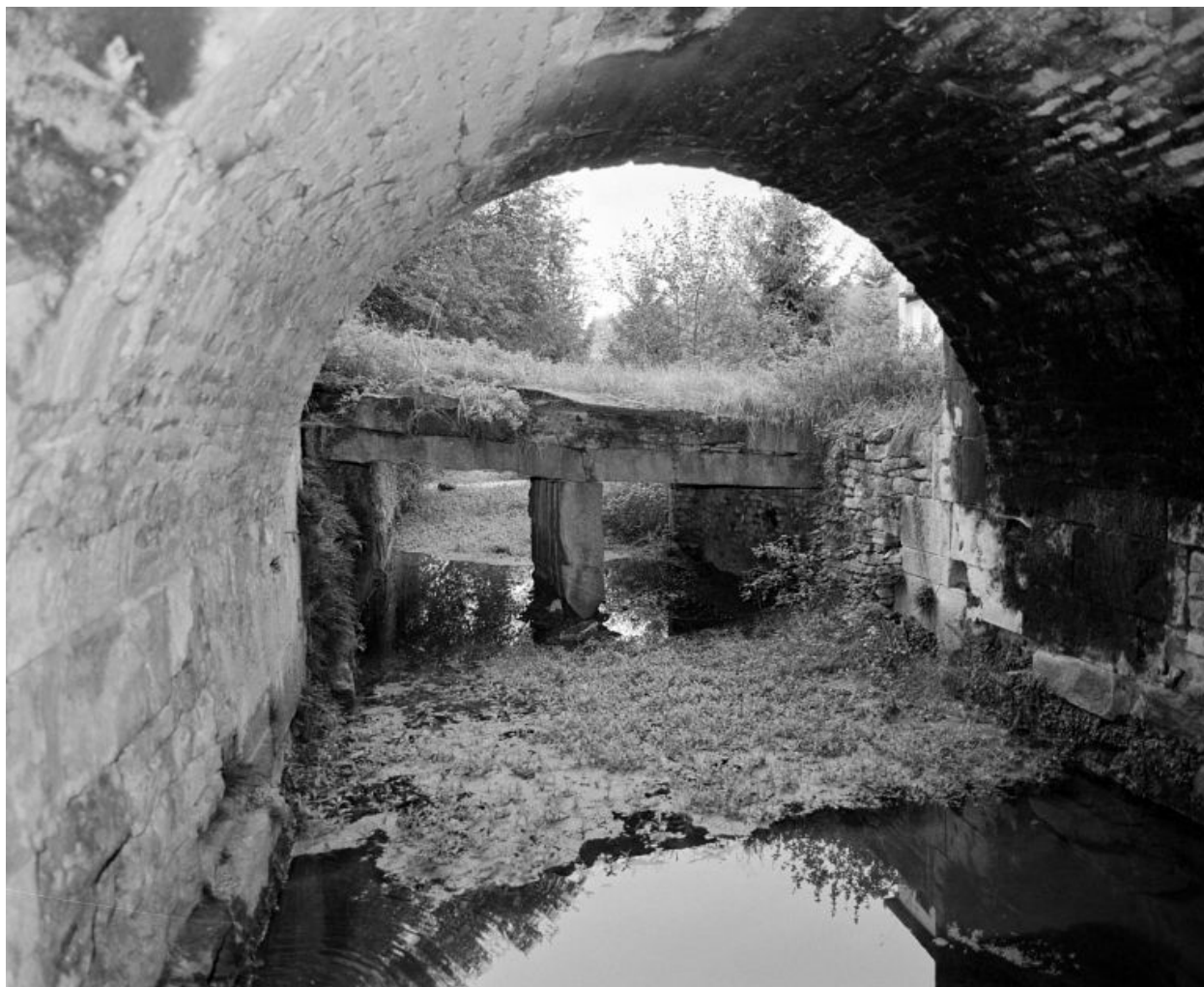
La chambre d'eau. Vue prise depuis la salle des turbines.
