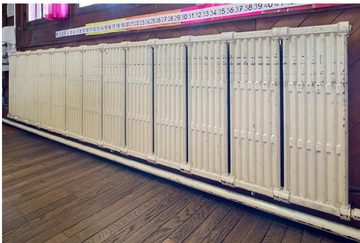
Les radiateurs d'une salle de classe.
