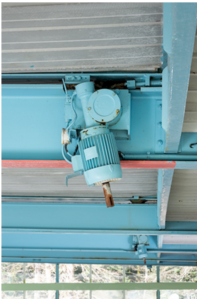
L'un des moteurs ouvrant le toit.
