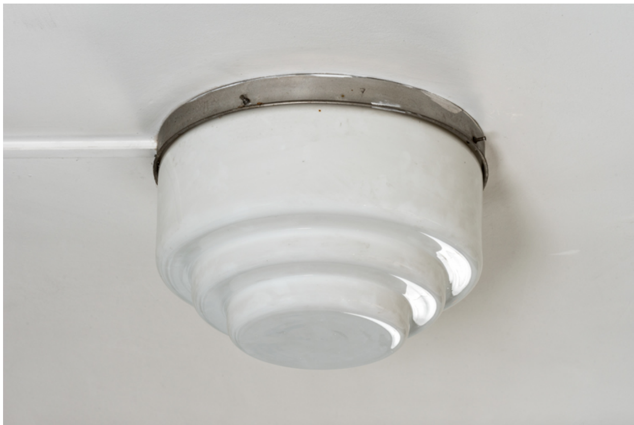
Galerie vitrée : luminaire d'applique.
