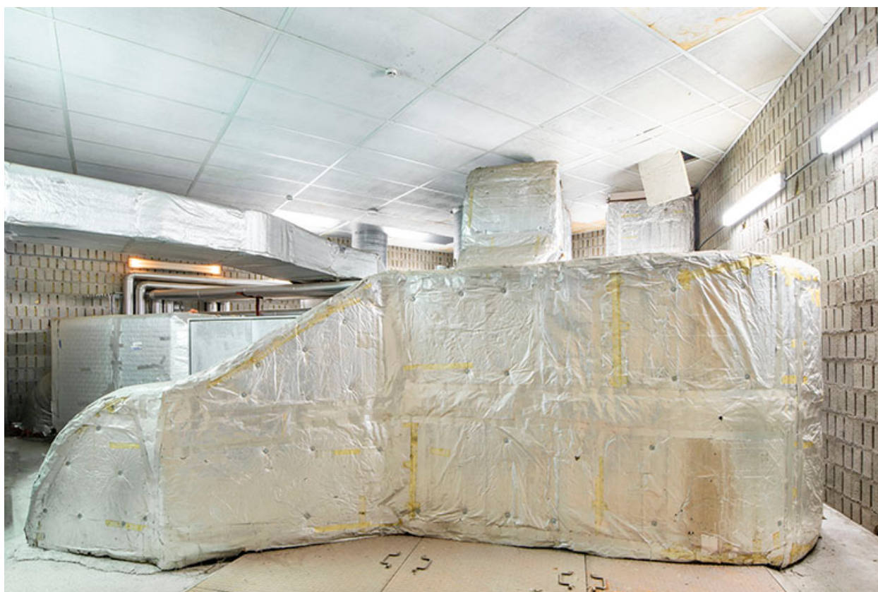
Grand Kursaal : local de la ventilation.
