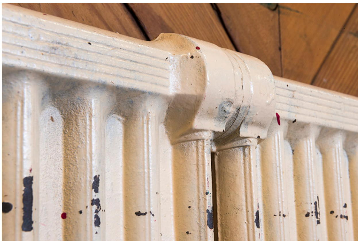
Détail d'un des radiateurs en fonte.
