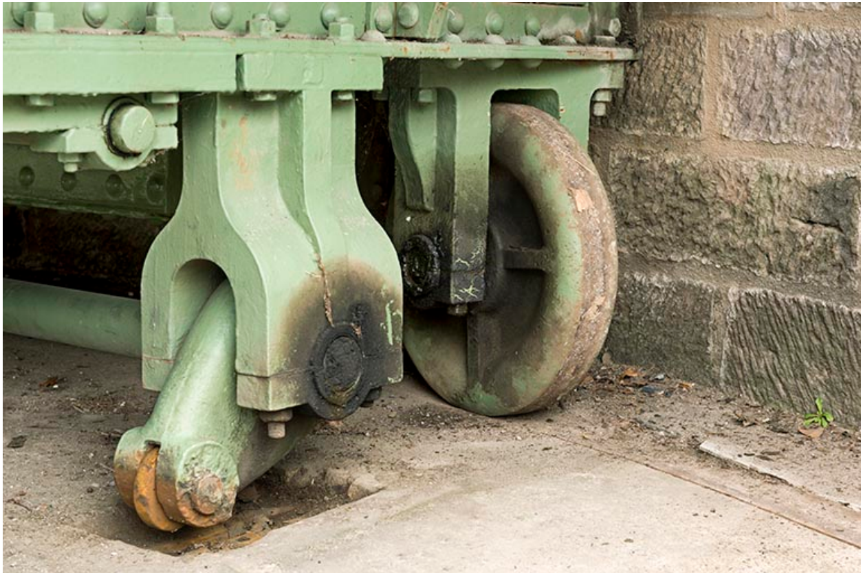
Système de calage levé (côté amont).
