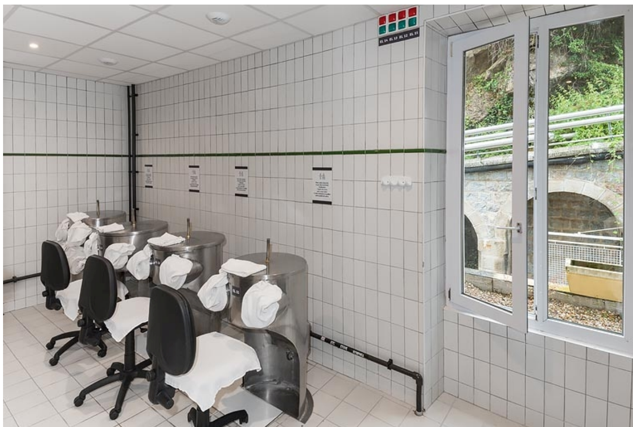
Étuves locales, au rez-de-chaussée (pavillon annexe de 1897).
