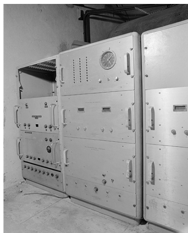
3e, 4e et 5e armoires, conservées à l'Observatoire. De gauche à droite,
