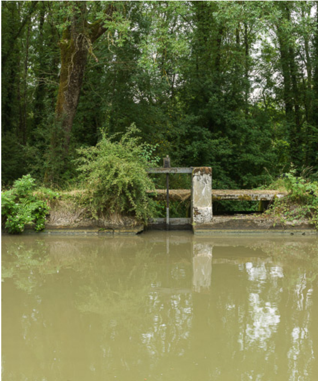
Vue de l'ensemble hydraulique.
