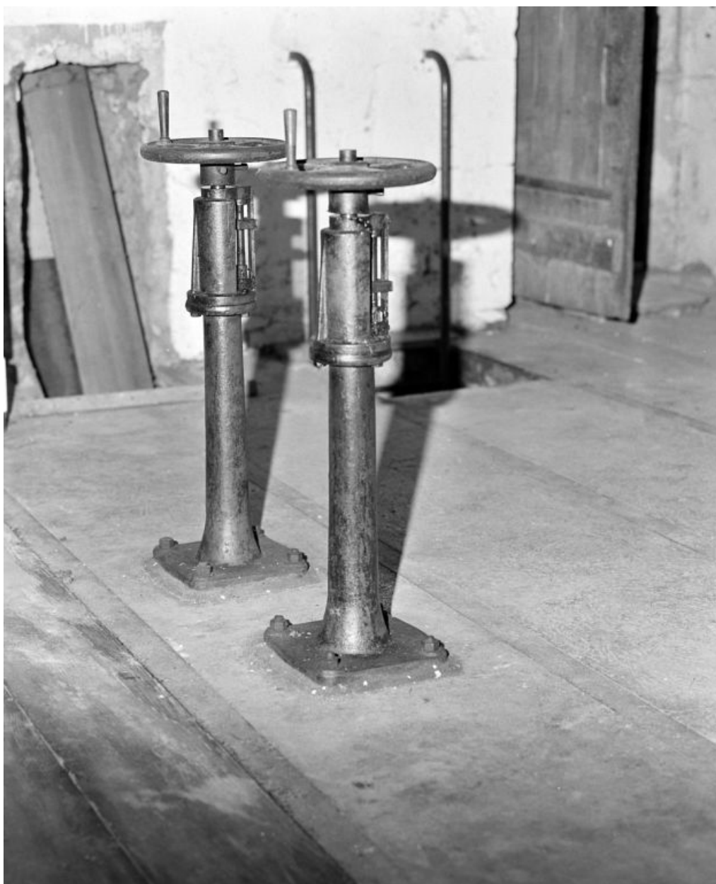
Rez-de-chaussée. Commandes d'ouverture des vannes.
