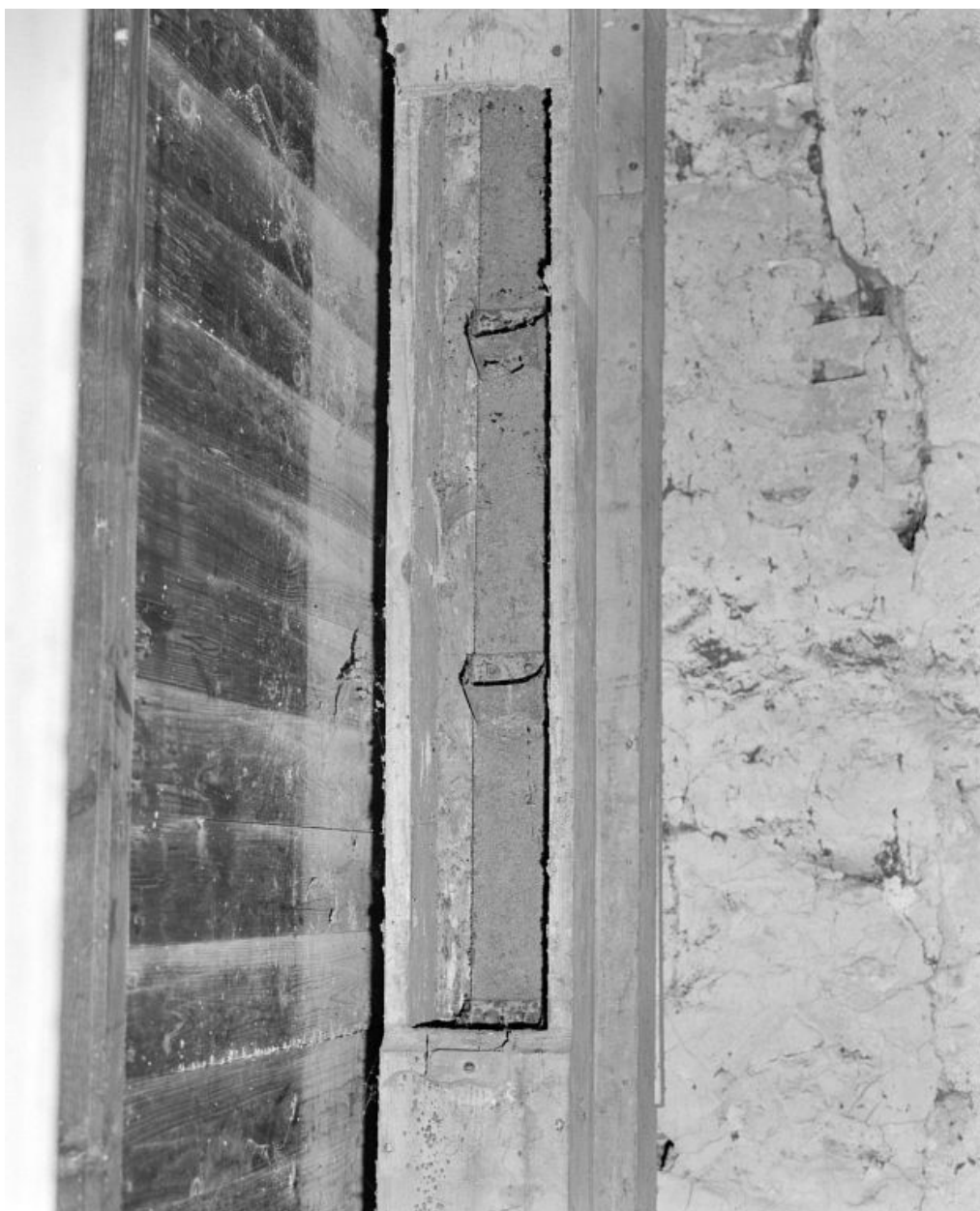
1er étage. Elévateur à godets, détail.
