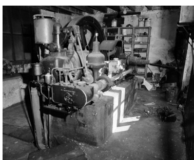
Rez-de-chaussée. Moteur diesel (L. Gardner, constructeur à Patricroft, Angleterre). Phot. Jean-Luc Duthu IVR26_20062106678X
