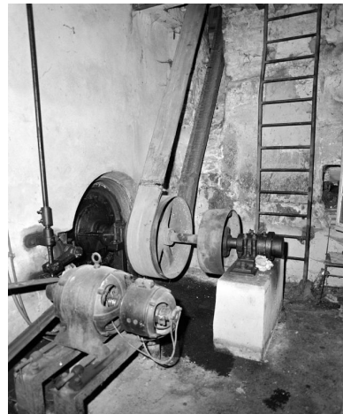
Etage de soubassement. Turbine et générateurs. Phot. Jean-Luc Duthu IVR26_20062106638X
