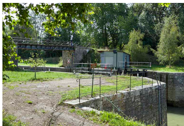
Le poste de commande de l'écluse. Phot. Sonia Dourlot IVR43_20157000883NUC2A
