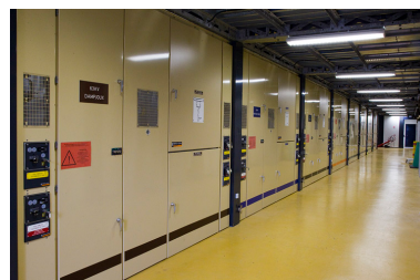
Transformateur RTE : intérieur.
