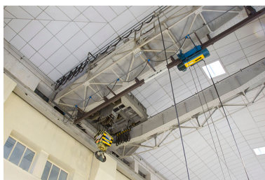
Centrale : face inférieure du pont roulant. Phot. Yves Sancey IVR43_20122502022NUC2A
