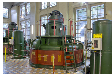
Centrale : groupe n° 3. Phot. Yves Sancey IVR43_20122502017NUC2A
