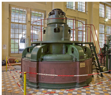
Centrale : groupe n° 4. Phot. Yves Sancey IVR43_20122502013NUC2A
