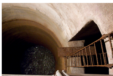
Tunnel d'amenée d'eau : cheminée d'équilibre. Phot. Yves Sancey IVR43_20122502038NUC2A
