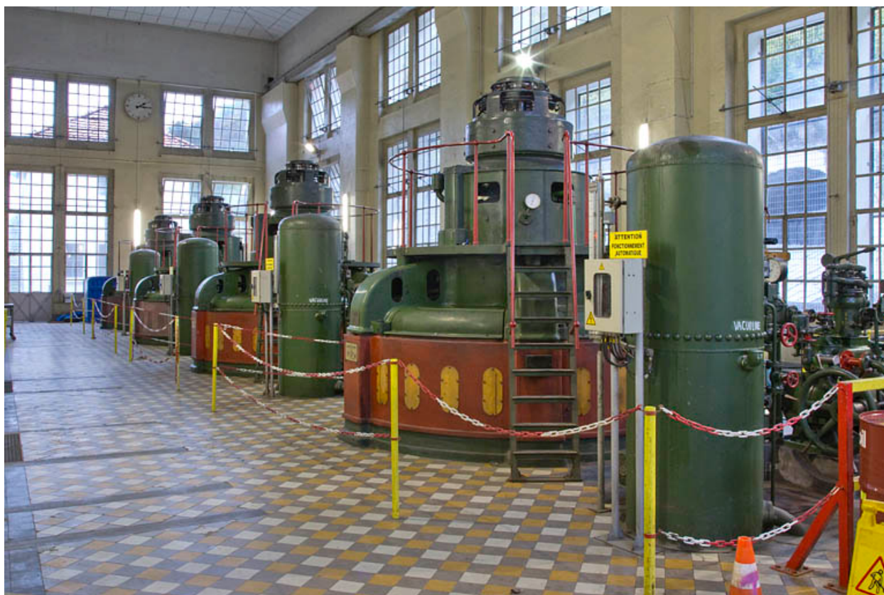
Centrale : vue d'ensemble des groupes (n° 1 à 4).
