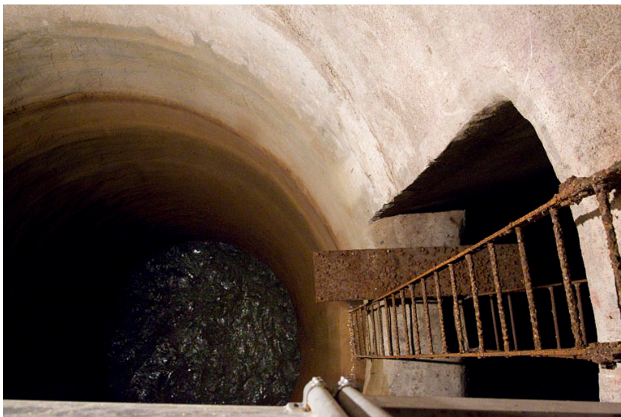
Tunnel d'amenée d'eau : cheminée d'équilibre.
