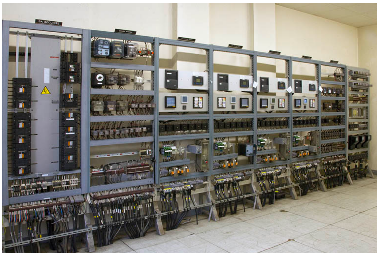
Centrale : salle de relayage des groupes.
