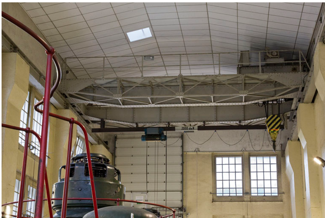
Centrale : pont roulant.
