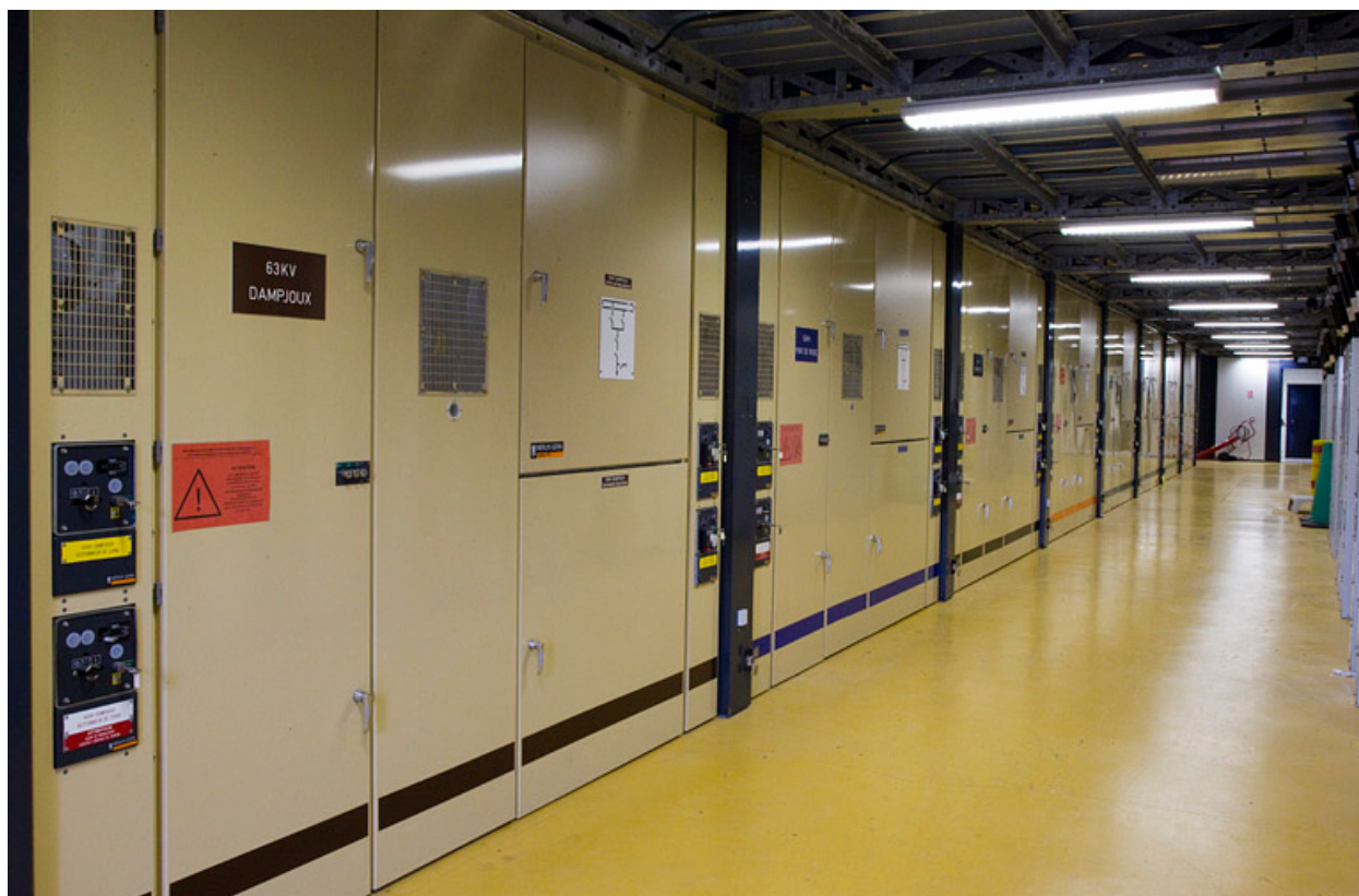
Transformateur RTE : intérieur.
