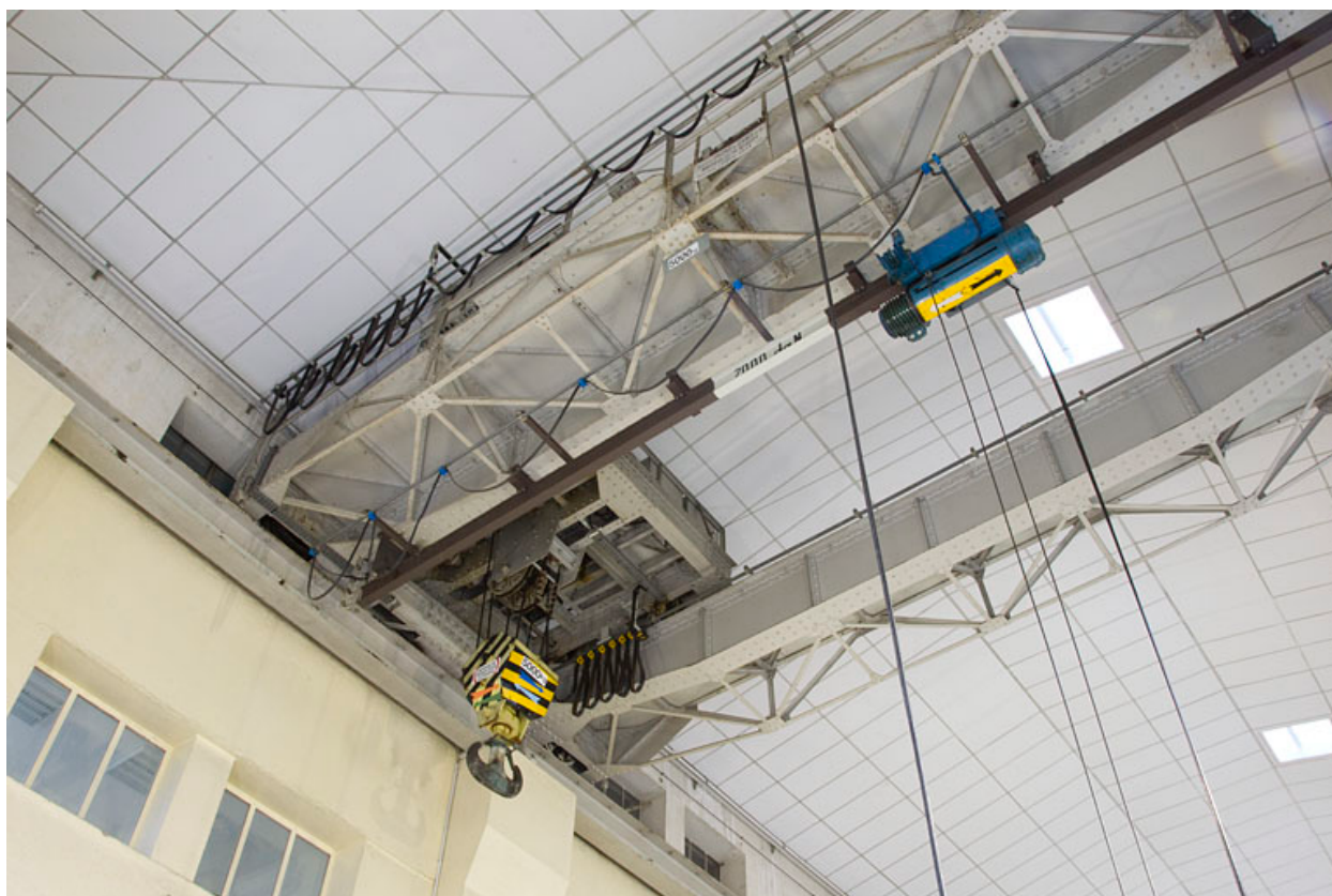
Centrale : face inférieure du pont roulant.
