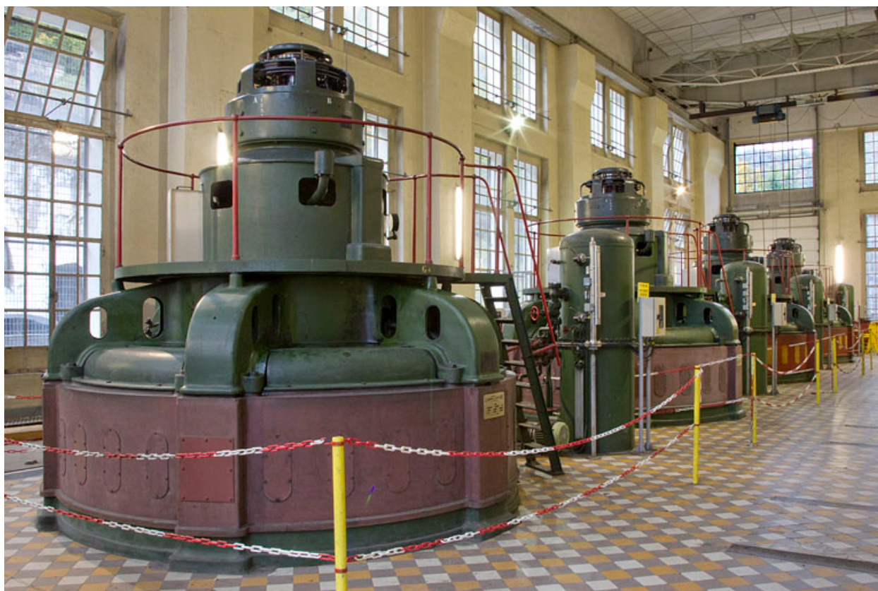
Centrale : vue d'ensemble des groupes (n° 4 à 1).
