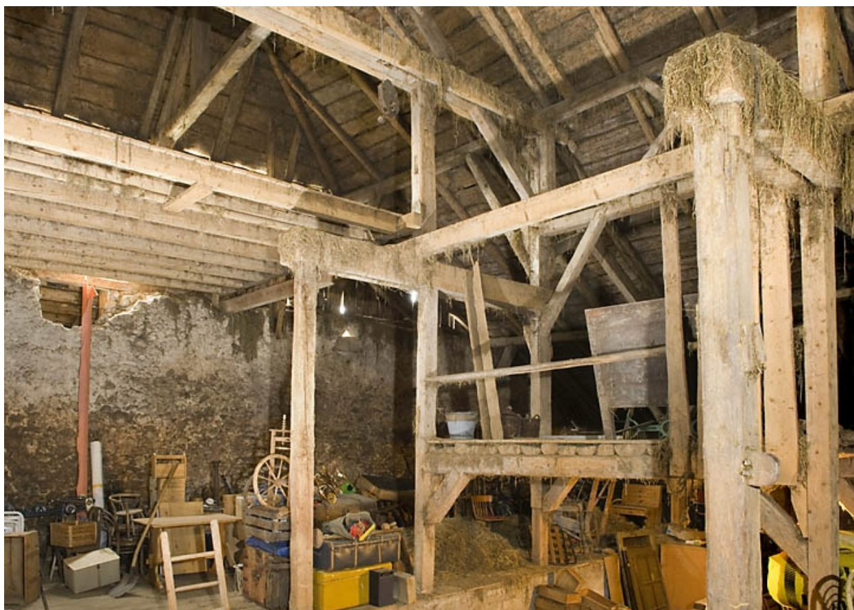
Déchargeuse : charpente et plateforme dans la grange.
