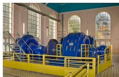
Centrale hydroélectrique du Refrain (Charquemont). Groupes turbo-alternateur. Phot. Yves Sancey IVR43_20122502121NUC2A
