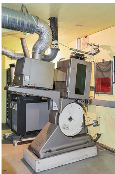
Cinéma Darcy-Palace : projecteur argentique Philips DP 70. Phot. Pierre-Marie Barbe-Richaud IVR26_20212100317NUC4A
