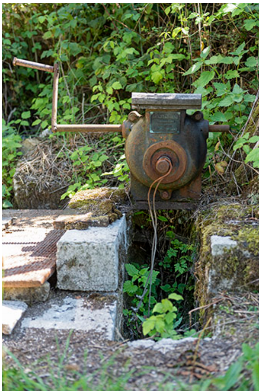
Commande de vanne près du hangar oriental.
