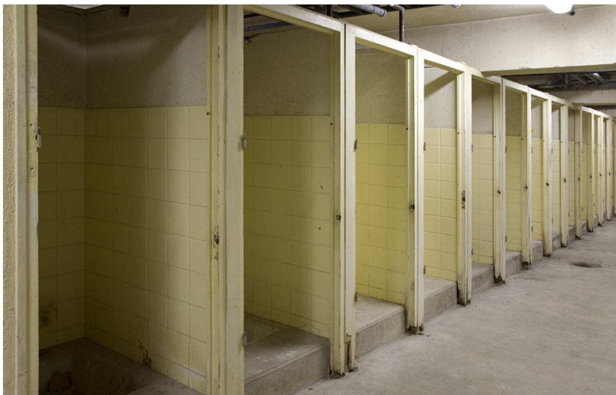
Bâtiment de l'hôtellerie (sous-sol) : bloc sanitaire désaffecté.
