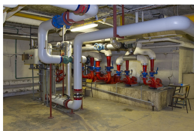
Externat (sous-sol), chaufferie : les pompes. Phot. Yves Sancey IVR43_20122500854NUC2A
