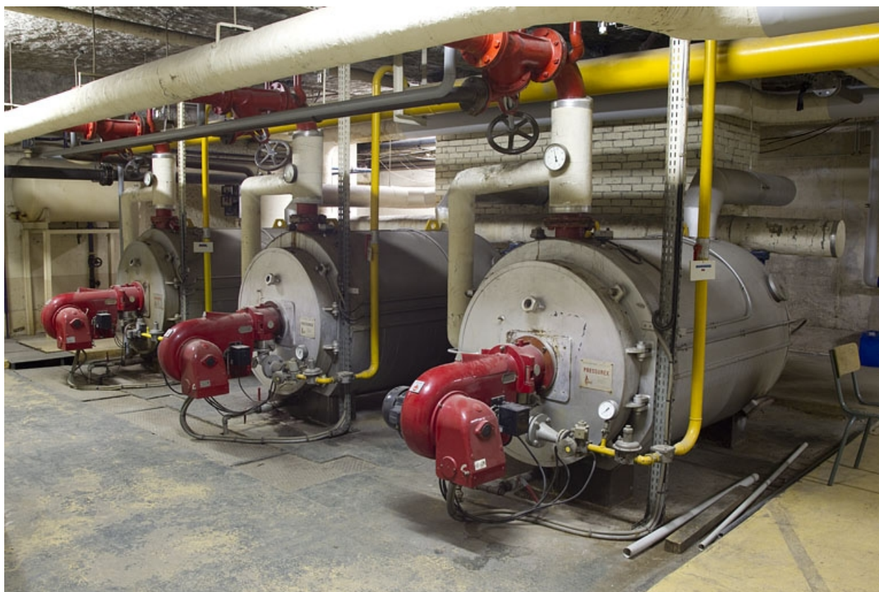
Externat (sous-sol), chaufferie : les chaudières.
