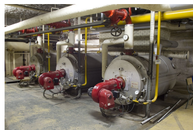
Externat (sous-sol), chaufferie : les chaudières. Phot. Yves Sancey IVR43_20122500853NUC2A
