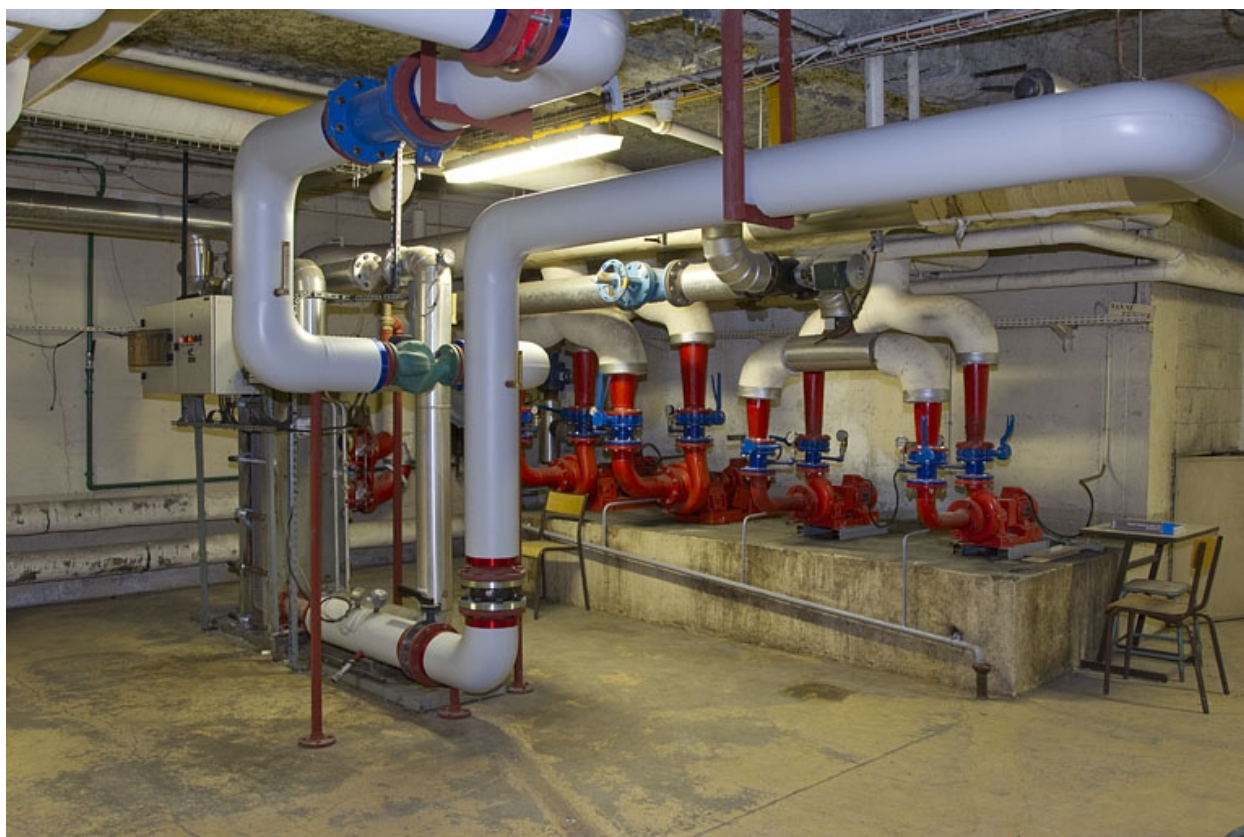
Externat (sous-sol), chaufferie : les pompes.
