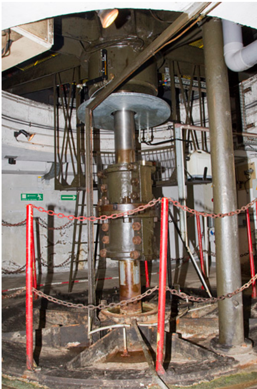
Détail de la transmission verticale d'une turbine.
