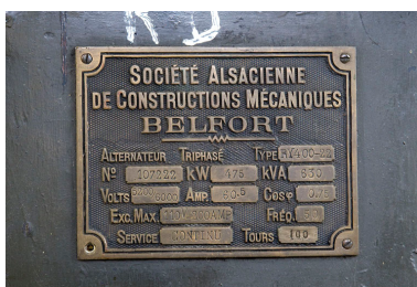
Plaque de constructeur d'un alternateur SACM. Phot. Yves Sancey IVR43_20122502060NUC2A
