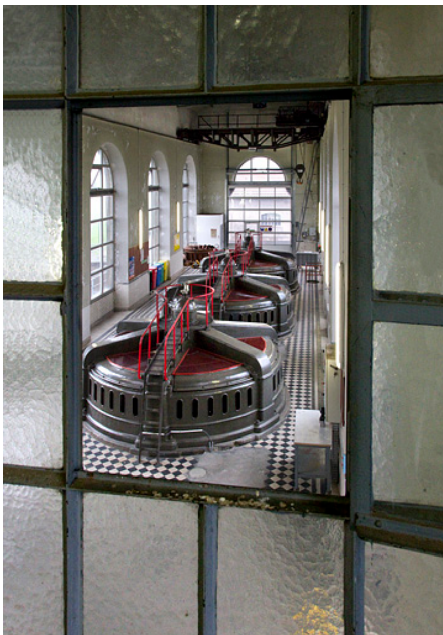
Vue plongeante sur la salle des machines.
