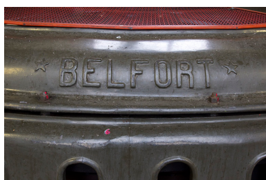
Détail de l'inscription d'un alternateur SACM. Phot. Yves Sancey IVR43_20122502063NUC2A
