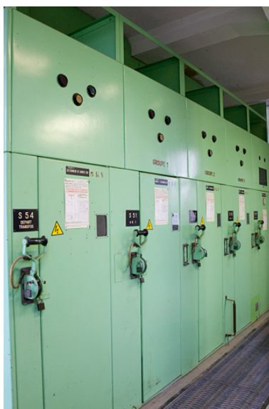
Armoires électriques. Phot. Yves Sancey IVR43_20122502067NUC2A
