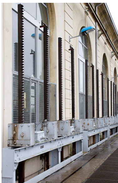
Crémaillères du vannage d'admission. Phot. Yves Sancey IVR43_20122502072NUC2A
