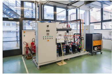
Atelier froid climatisation domotique. Phot. Jérôme Mongreville IVR43_20137000599NUC4A
