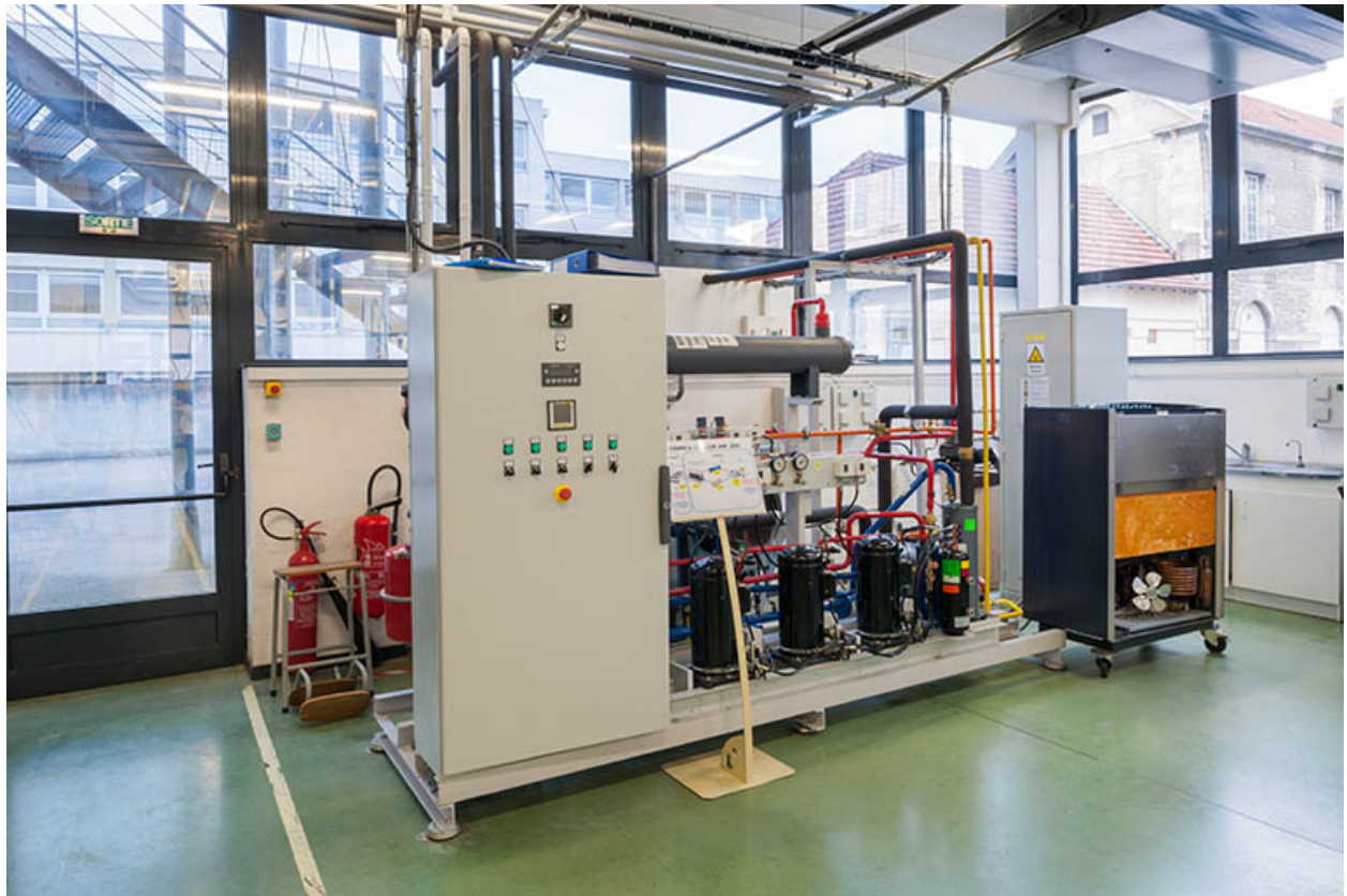
Atelier froid climatisation domotique.
