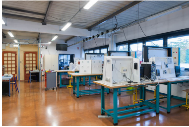
Dans l'atelier froid, climatisation et domotique. Phot. Jérôme Mongreville IVR43_20137000601NUC4A
