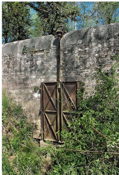
Vanne de l'aqueduc.
