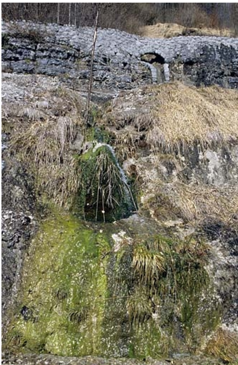
Ecoulement à gauche de la voie, à proximité de la descente d'eau.
