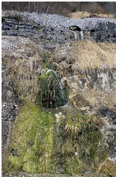
Ecoulement à gauche de la voie, à proximité de la descente d'eau. Phot. Yves Sancey IVR43_20053900634ZA
