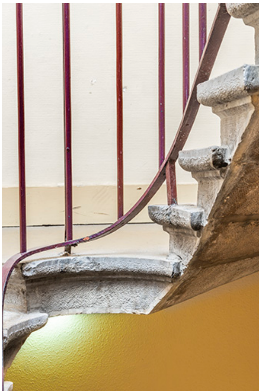
Bâtiment d'entrée : extrémité des marches de l'escalier de l'administration au niveau d'un repos.
