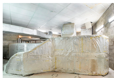
Grand Kursaal : local de la ventilation. Phot. Jérôme Mongreville IVR43_20232500209NUC4A
