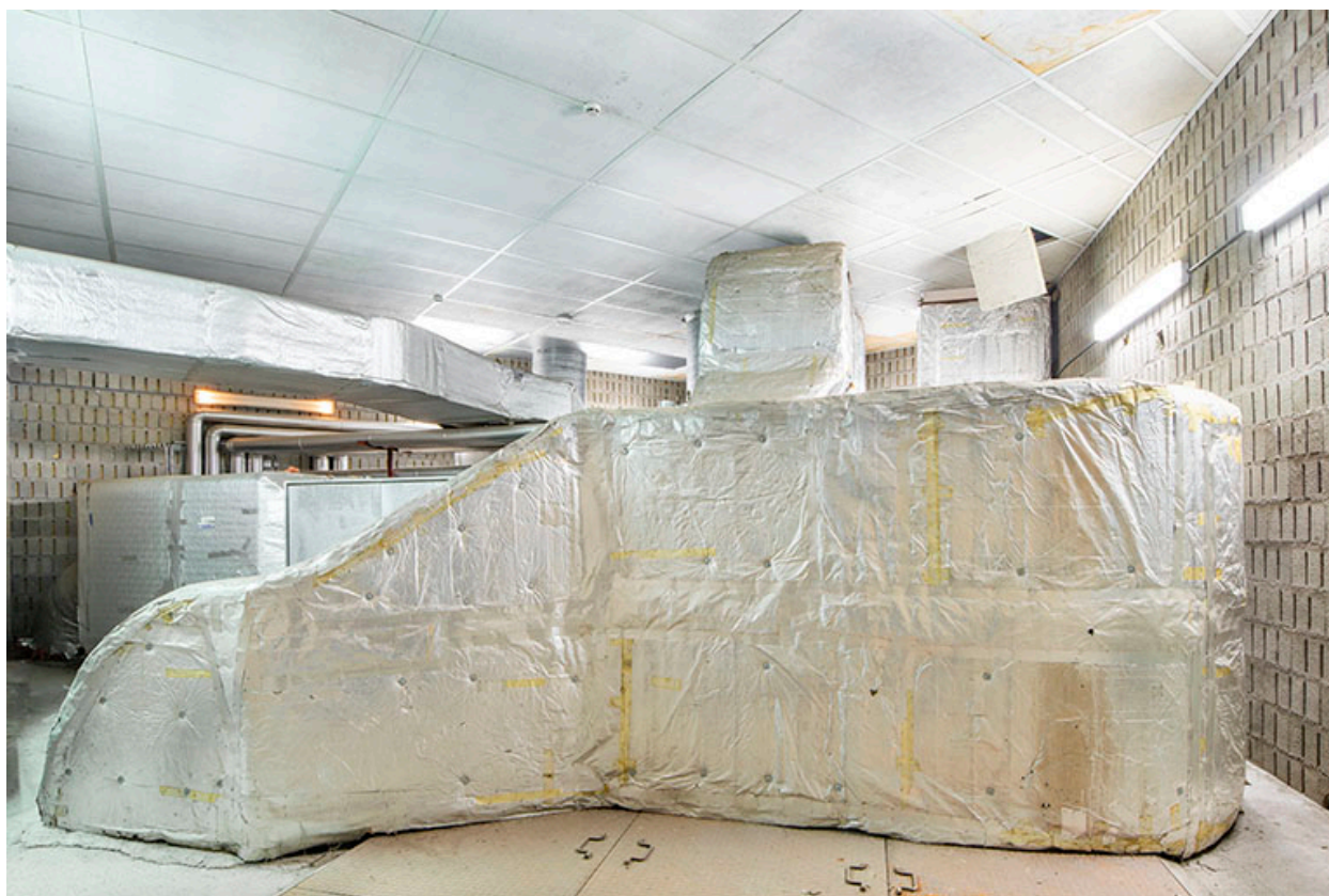
Grand Kursaal : local de la ventilation.
