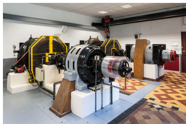
Groupes turbo-alternateurs en service. Phot. Jérôme Mongreville IVR43_20152501772NUC4A
