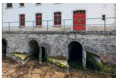
Conduits d'évacuation des groupes turbo-alternateurs. Phot. Jérôme Mongreville IVR43_20152501768NUC4A
