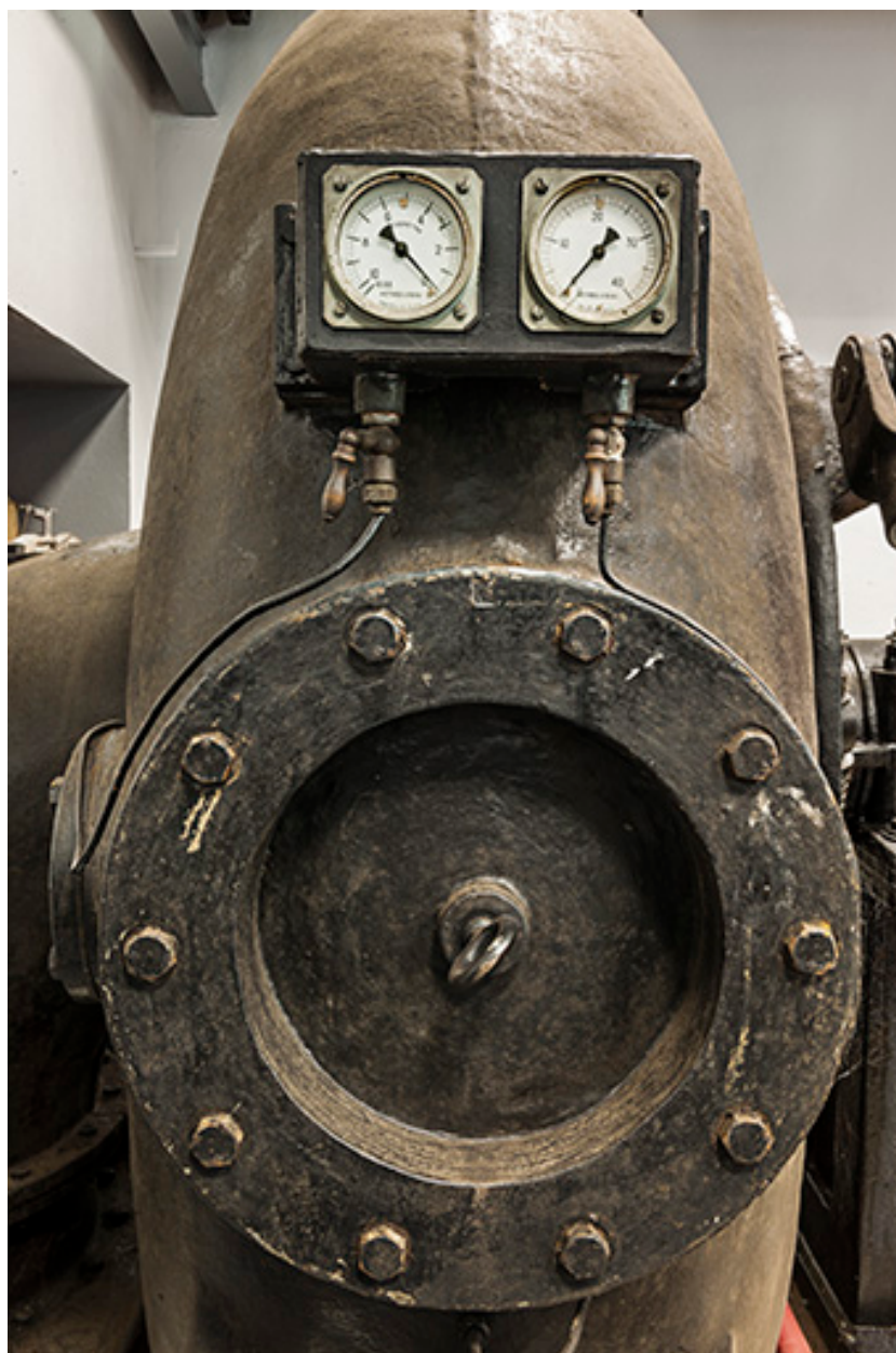
Bâche de la turbine du groupe 4.
