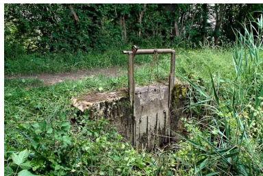
Vue rapprochée de la vanne de l'aqueduc.
