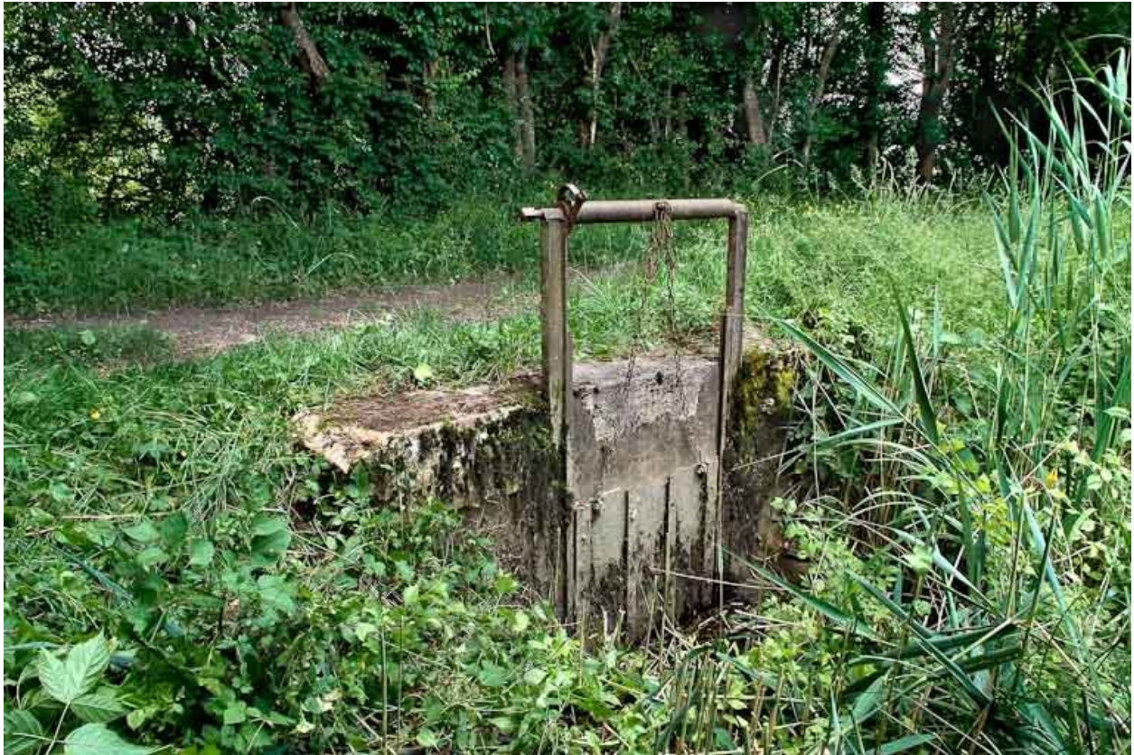
Vue rapprochée de la vanne de l'aqueduc.
