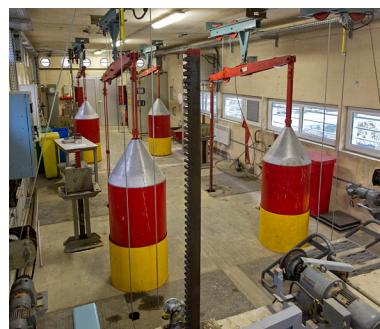
Barrage : soupapes des vannes toit. Chaque vanne toit est manoeuvrée
