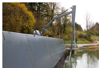
Prise d'eau : dégrilleur en fonctionnement. Phot. Yves Sancey IVR43_20122502089NUC2A
