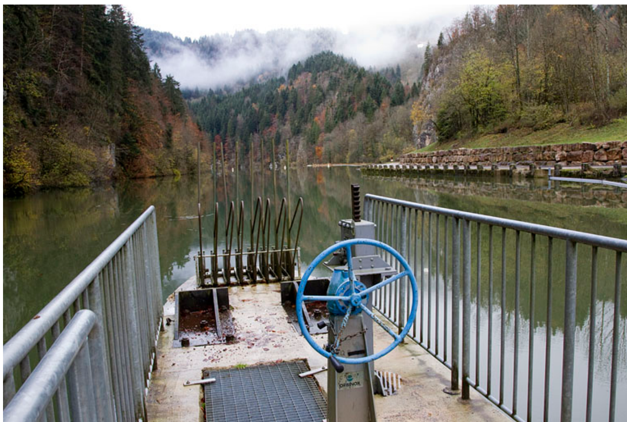
Barrage : commande de vanne de fond.
