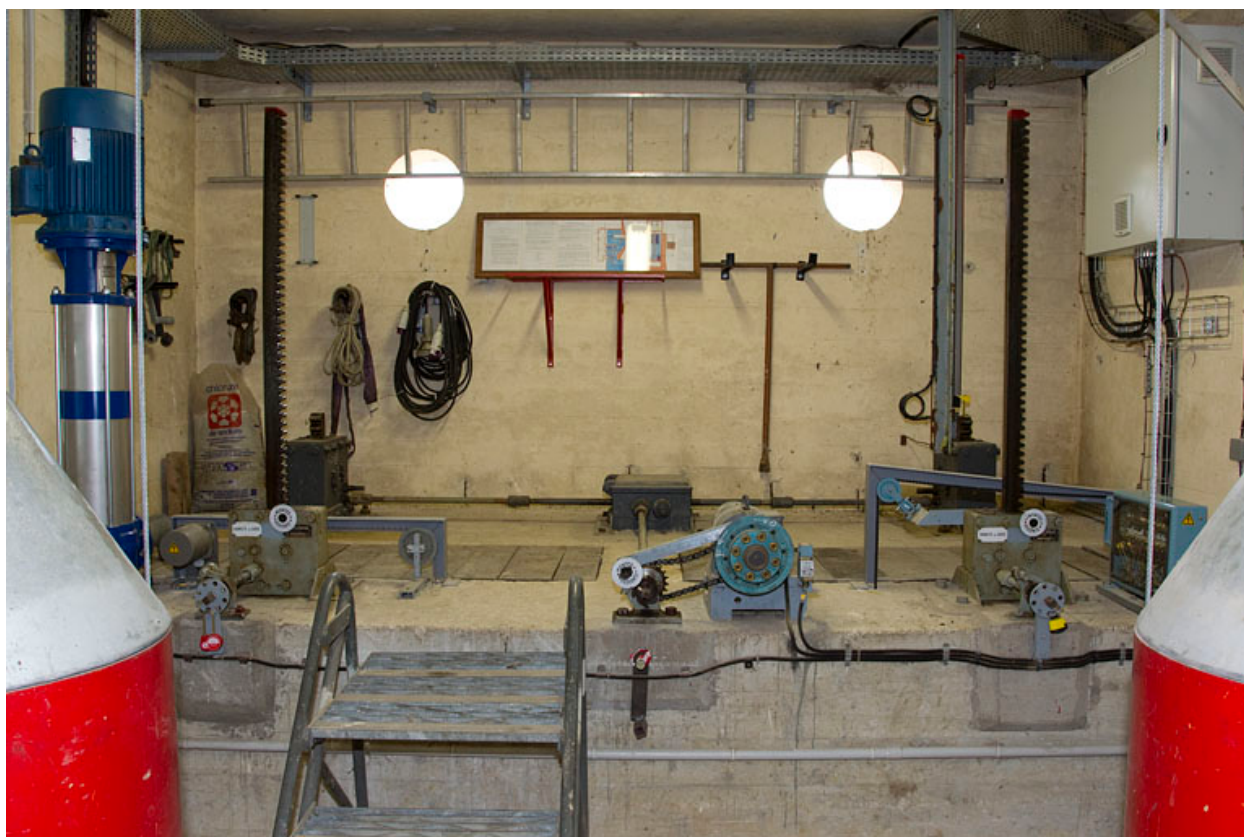
Barrage : commande des vannes de garde.
