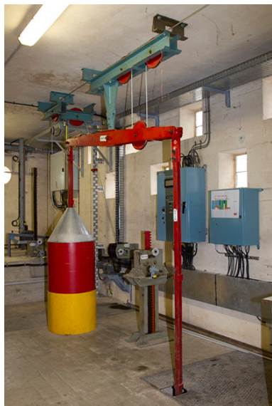
Barrage : soupape d'une vanne toit.
