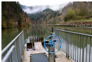
Barrage : commande de vanne de fond. Phot. Yves Sancey IVR43_20122502109NUC2A
