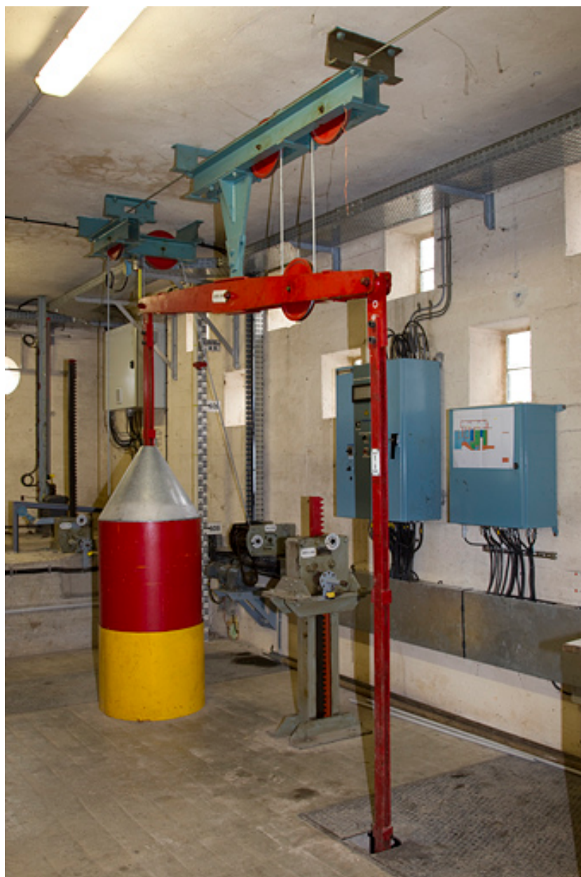
Barrage : soupape d'une vanne toit.
