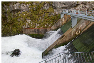
Barrage : vue plongeante sur les vannes toit. Phot. Yves Sancey IVR43_20122502105NUC2A
