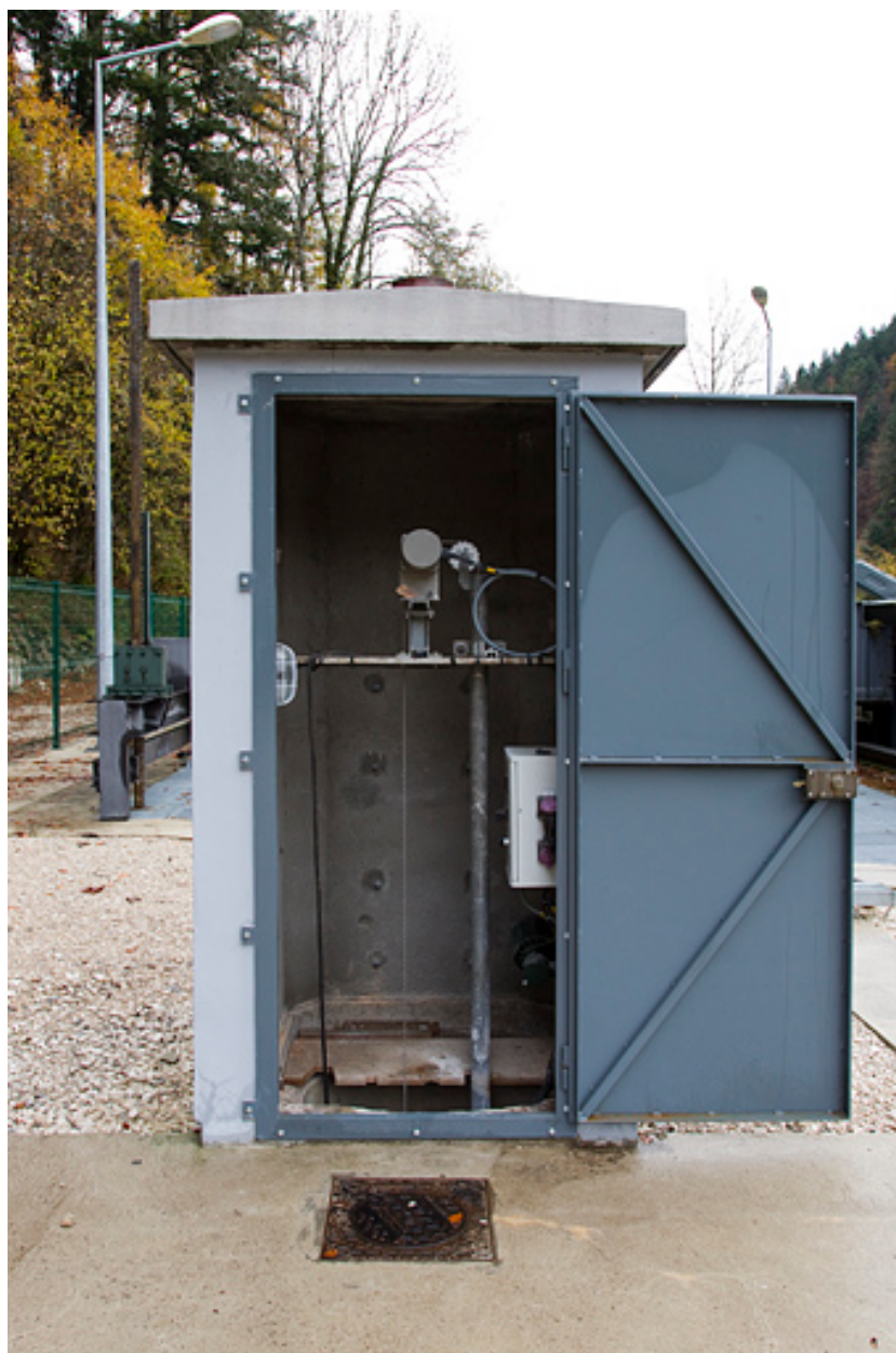
Prise d'eau : édicule et puits limnimétrique.
