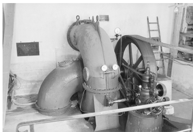
Turbine Schneider Jacquet et Cie. Phot. Laurent Poupard IVR43_19913901154Z
