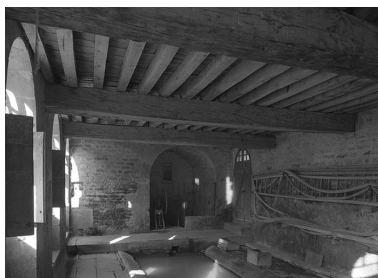
Vue intérieure. Lavoir. Phot. Michel Thierry IVR26_19748900718V
