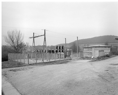
Transformateur et salle des machines. Phot. Jérôme Mongreville IVR43_19963900138X
