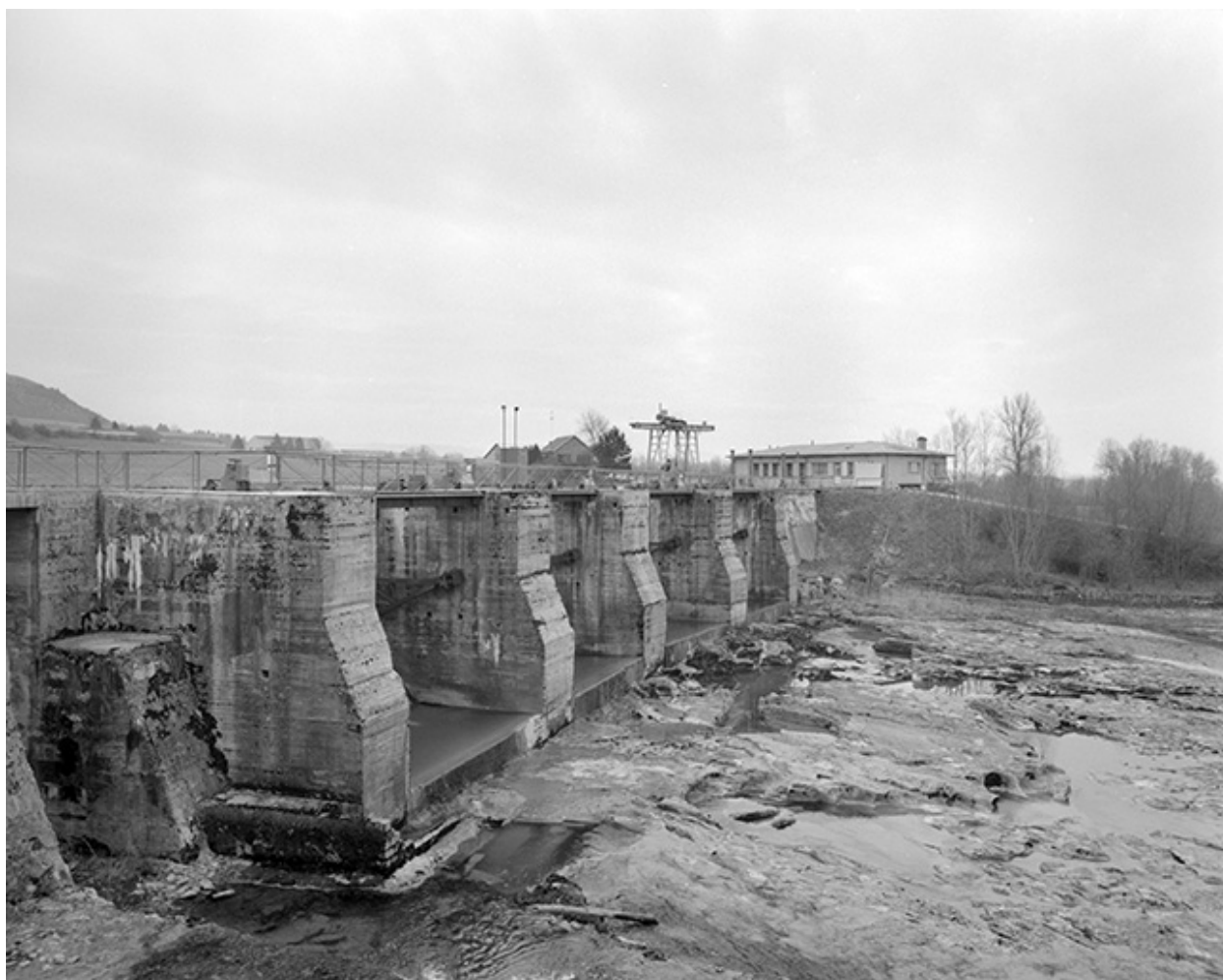
Barrage et vannes-secteurs.
