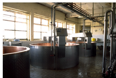
Cuves Chalon Mégard. Phot. Jérôme Mongreville IVR43_19953900220ZA
