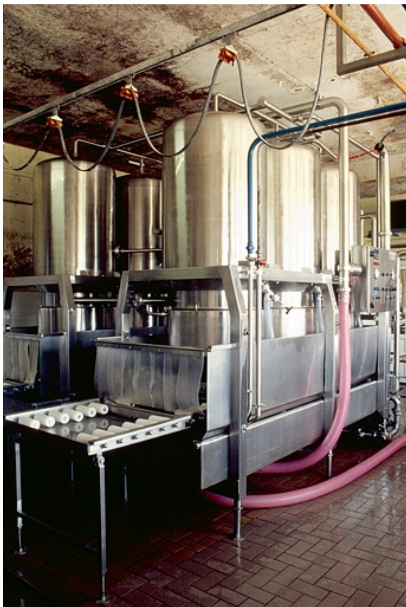
Cloches de l'installation de soutirage sous vide.
