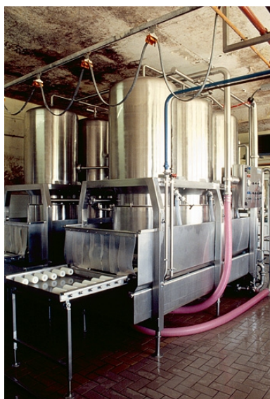
Cloches de l'installation de soutirage sous vide. Phot. Jérôme Mongreville IVR43_19953900238ZA
