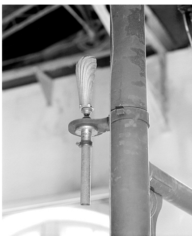
Système d'éclairage. Phot. Jérôme Mongreville IVR43_20042500038X
