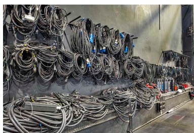
Salle, mur du fond de scène, câbles.
