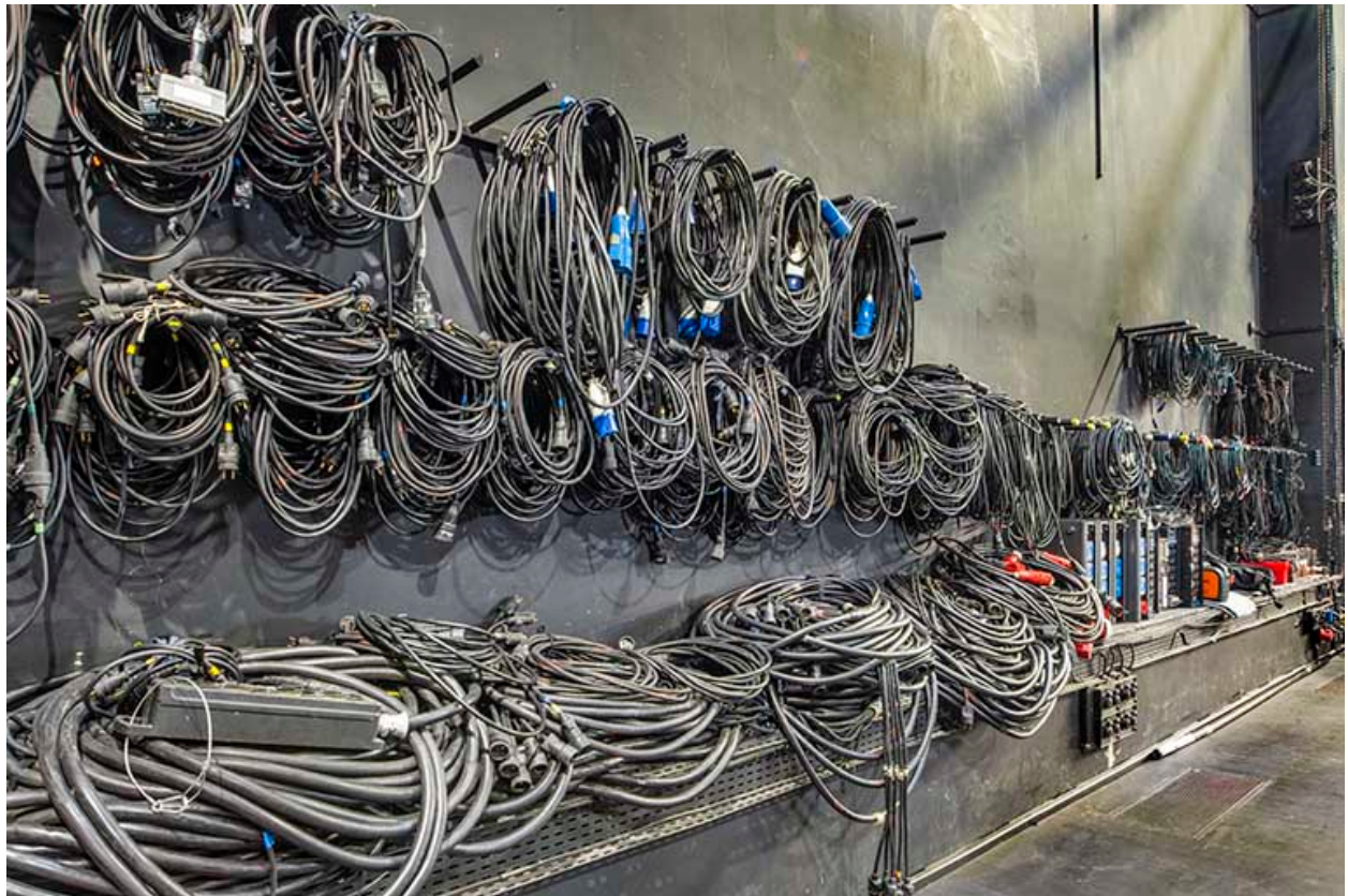
Salle, mur du fond de scène, câbles.
