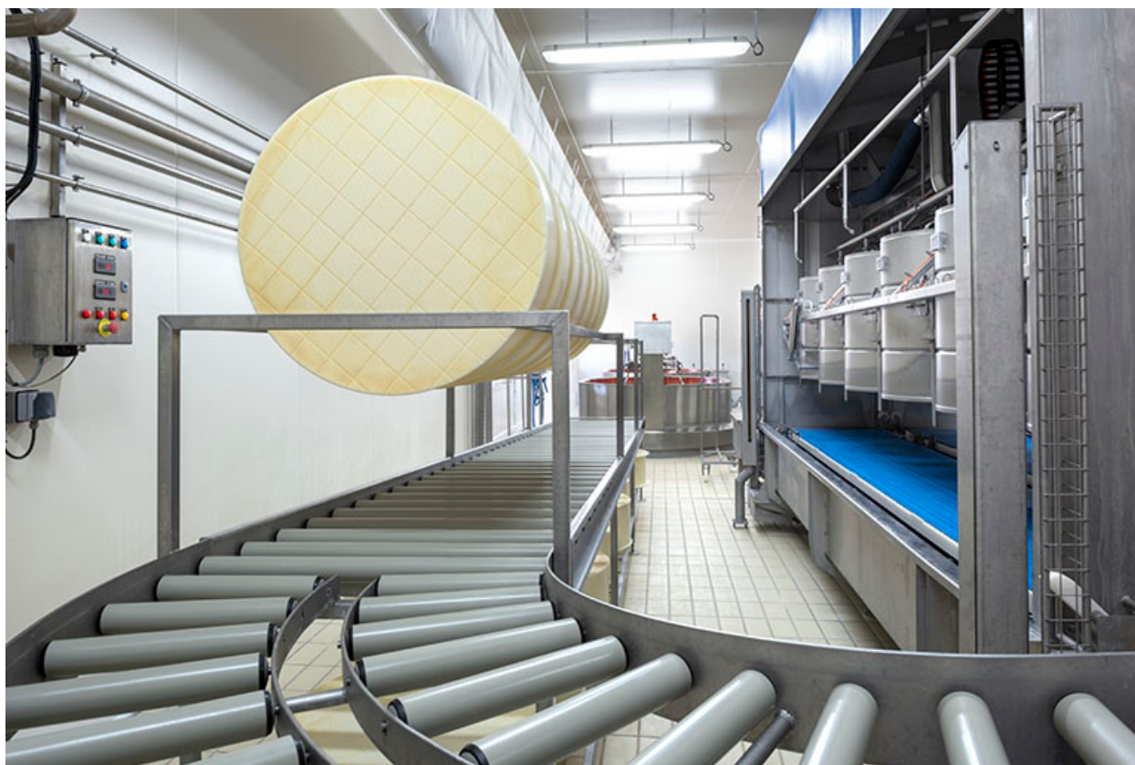
Installation de moulage et convoyeur.
