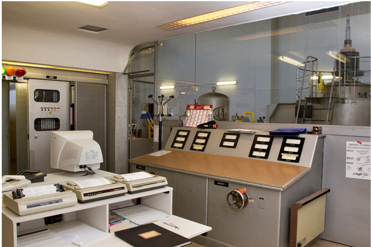
Poste de commande.
