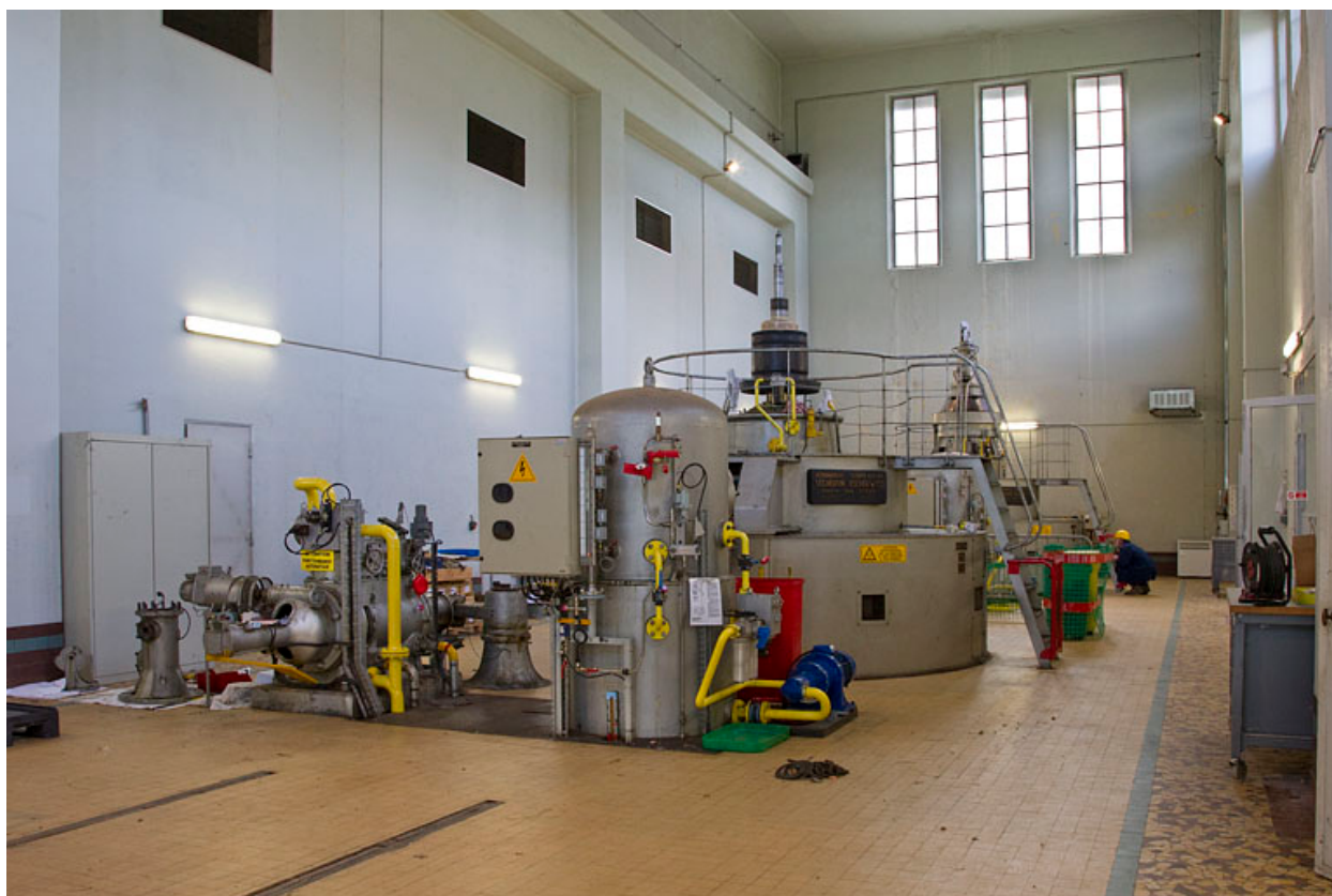
Intérieur de la salle des machines.
