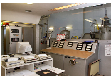
Poste de commande. Phot. Yves Sancey IVR43_20122502186NUC2A
