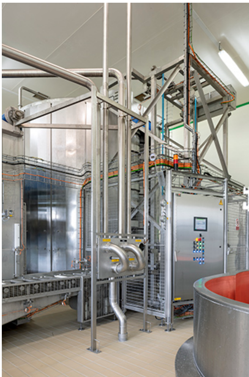
Installation de pressage (tour à l'arrière-plan).
