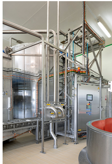
Installation de pressage (tour à l'arrière-plan). Phot. Sonia Dourlot IVR43_20192500684NUC4A
