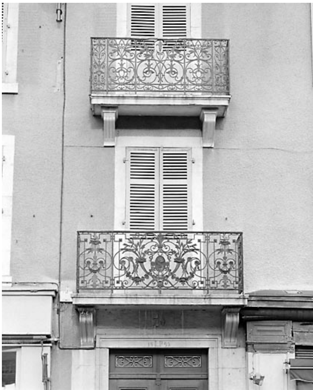
Balcons surmontant la porte d'entrée, avant restauration.
