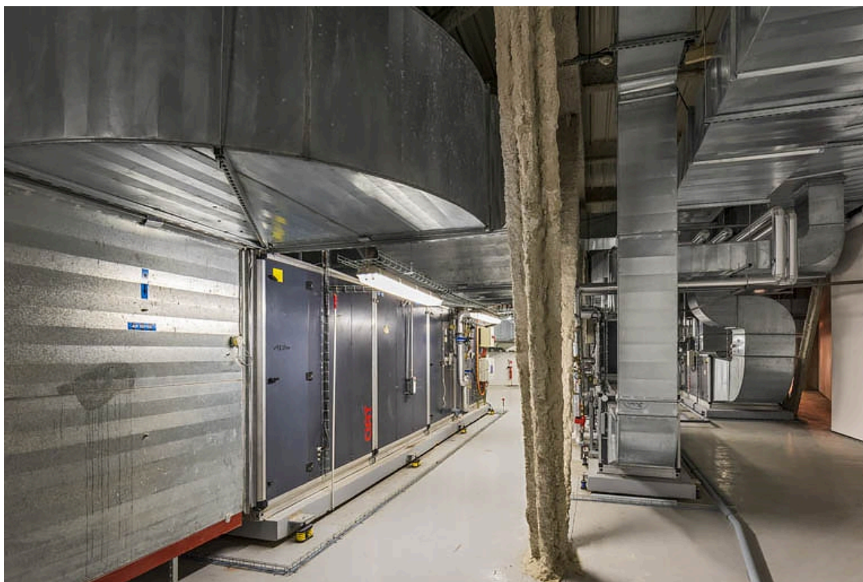
Ventilation dans le comble (les équipements sont fixés sur silentblocs).
