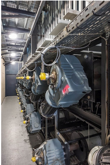
Equipes contrebalancées (fils, poulies, contrepoids, etc., permettant de manoeuvrer les perches) : moteurs électriques. Phot. Pierre-Marie Barbe-Richaud IVR26_20212100146NUC4A
