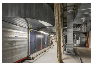
Ventilation dans le comble (les équipements sont fixés sur silentblocs). Phot. Pierre-Marie Barbe-Richaud IVR26_20212100163NUC4A
