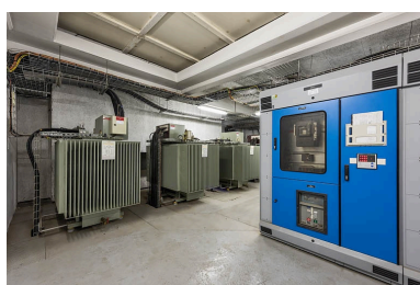
Salle de l'alimentation électrique. Phot. Pierre-Marie Barbe-Richaud IVR26_20212100177NUC4A
