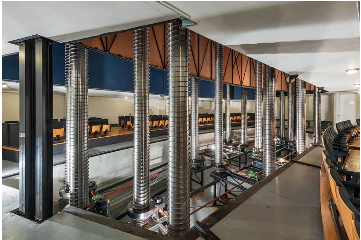
Avant-scène : colonnes Spiralift soutenant le plancher de la fosse d'orchestre.
