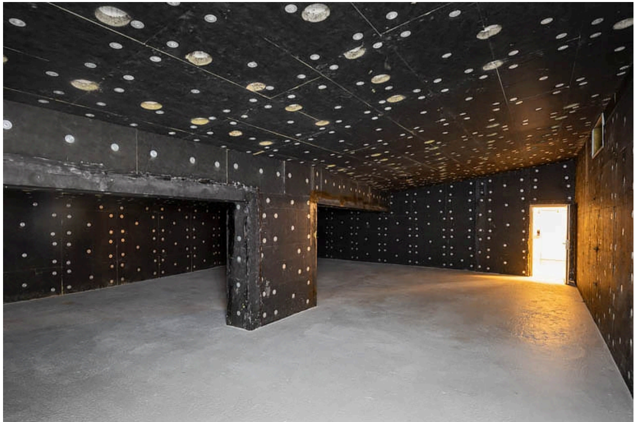
Plénum (en sous-sol) destiné à la ventilation de la salle.
