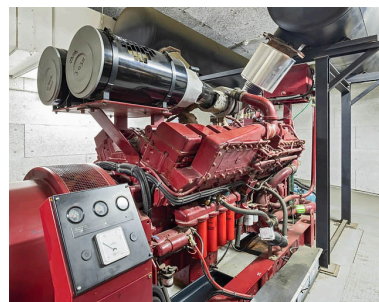
Groupe électrogène de secours (détail). Phot. Pierre-Marie Barbe-Richaud IVR26_20212100157NUC4A
