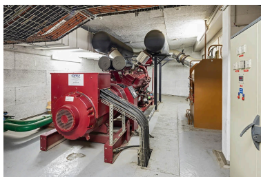
Groupe électrogène de secours. Phot. Pierre-Marie Barbe-Richaud IVR26_20212100156NUC4A
