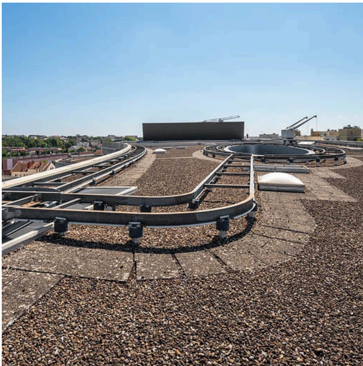
Toit terrasse au-dessus de la salle : rail du chariot permettant le déplacement de la nacelle utilisée pour le nettoyage des façades.
