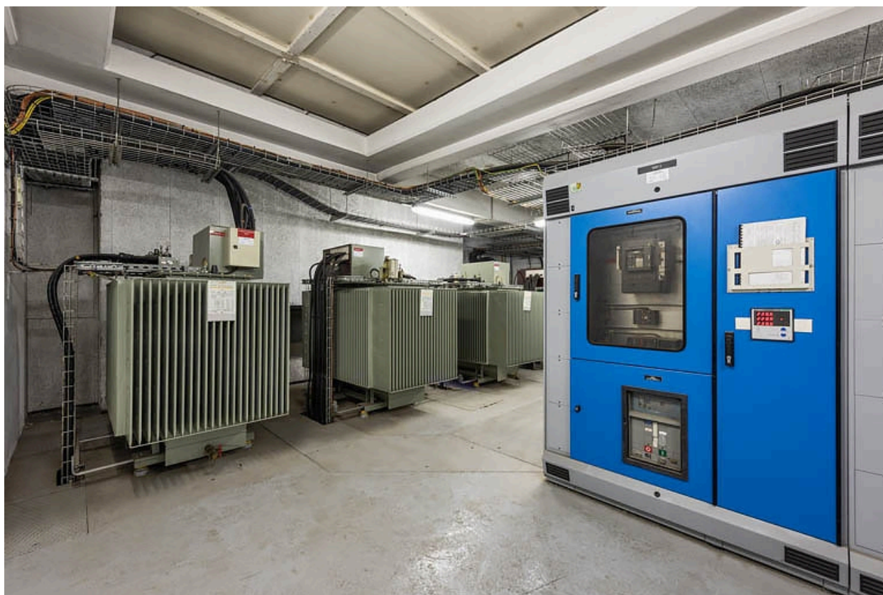
Salle de l'alimentation électrique.
