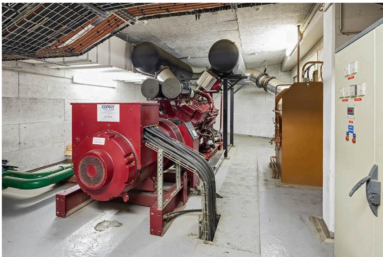
Groupe électrogène de secours.
