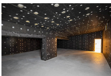
Plénum (en sous-sol) destiné à la ventilation de la salle. Phot. Pierre-Marie Barbe-Richaud IVR26_20212100164NUC4A
