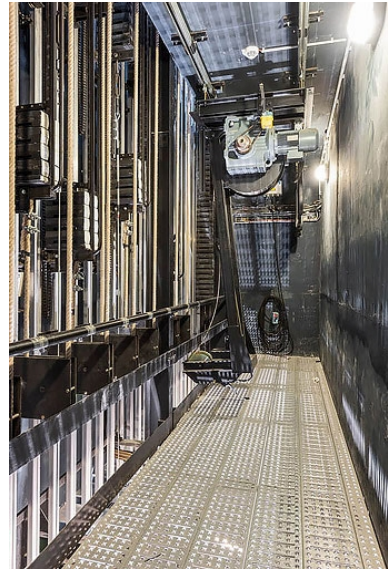
Equipes contrebalancées : niveau des contrepoids. Phot. Pierre-Marie Barbe-Richaud IVR26_20212100147NUC4A
