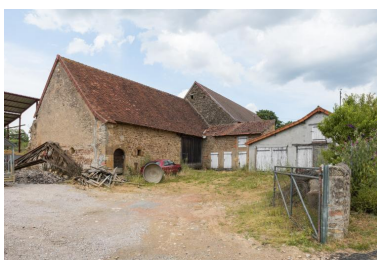
Vue des anciennes dépendances, partiellement détruites Phot. Pierre-Marie Barbe-Richaud IVR26_20187100155NUC4A
