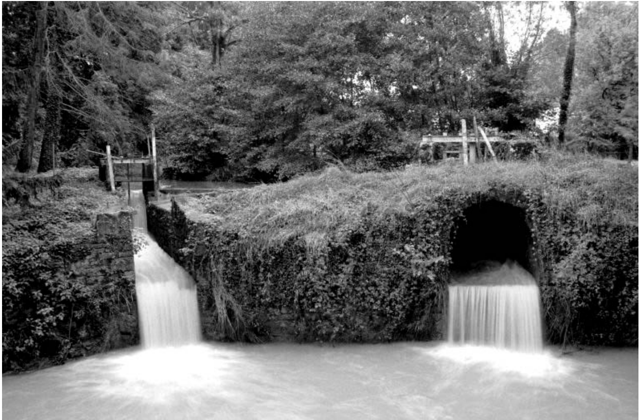
Vannes de décharge.
