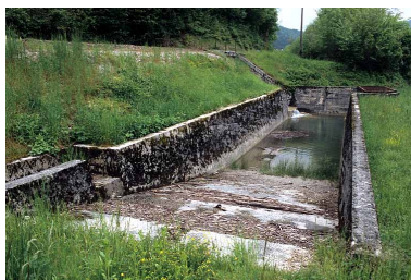
Réservoir. Phot. Yves Sancey IVR43_20053900865ZA
