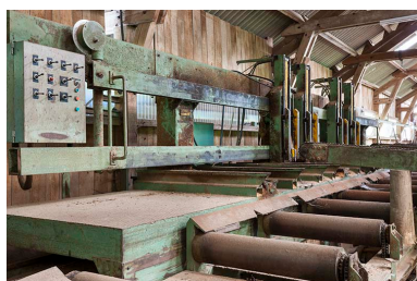
Détail du convoyeur de la scie à ruban. Phot. Jérôme Mongreville IVR43_20152501838NUC4A
