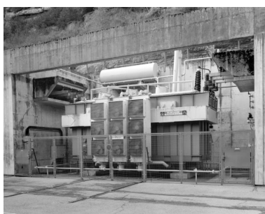
Transformateur Alsthom de 160 MVA. Phot. Jérôme Mongreville IVR43_19913900698X
