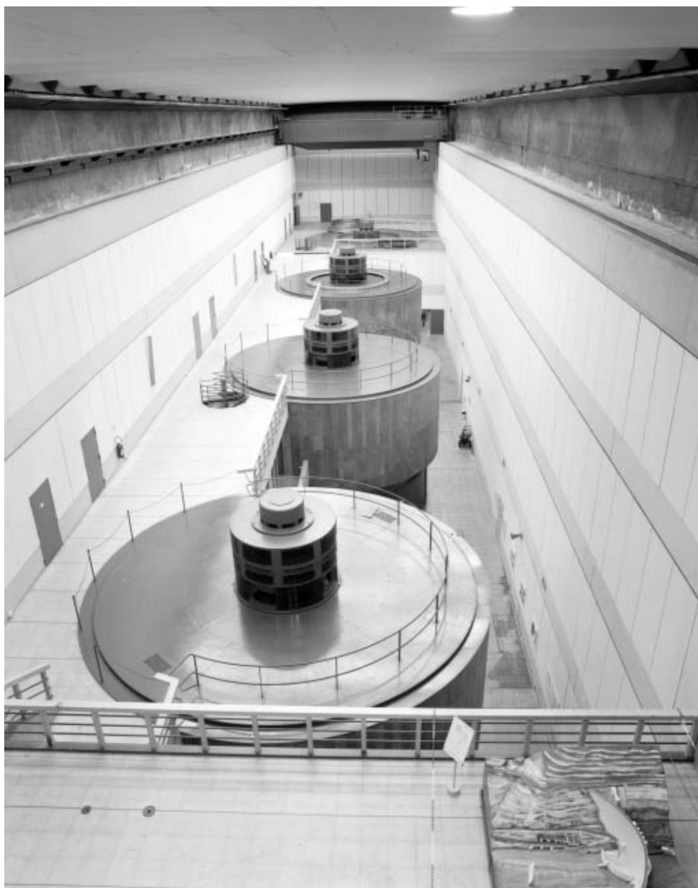
Vue d'ensemble de la salle des machines.
