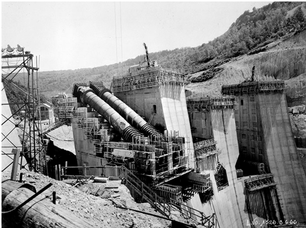
Barrage - Conduites vidanges.
