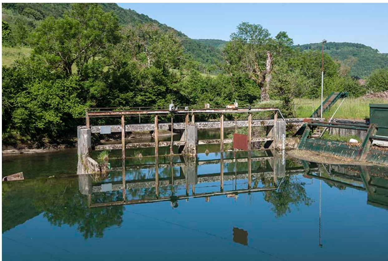
Vannage du barrage.
