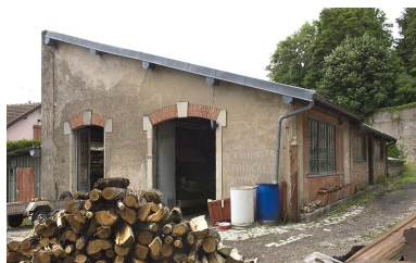
Vestige d'un atelier incendié. Phot. Jérôme Mongreville IVR43_20097000651NUC2A
