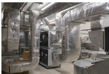
Machinerie d'extraction d'air du p le h telier. Phot. Sonia Dourlot IVR43_20147000183NUC2A
