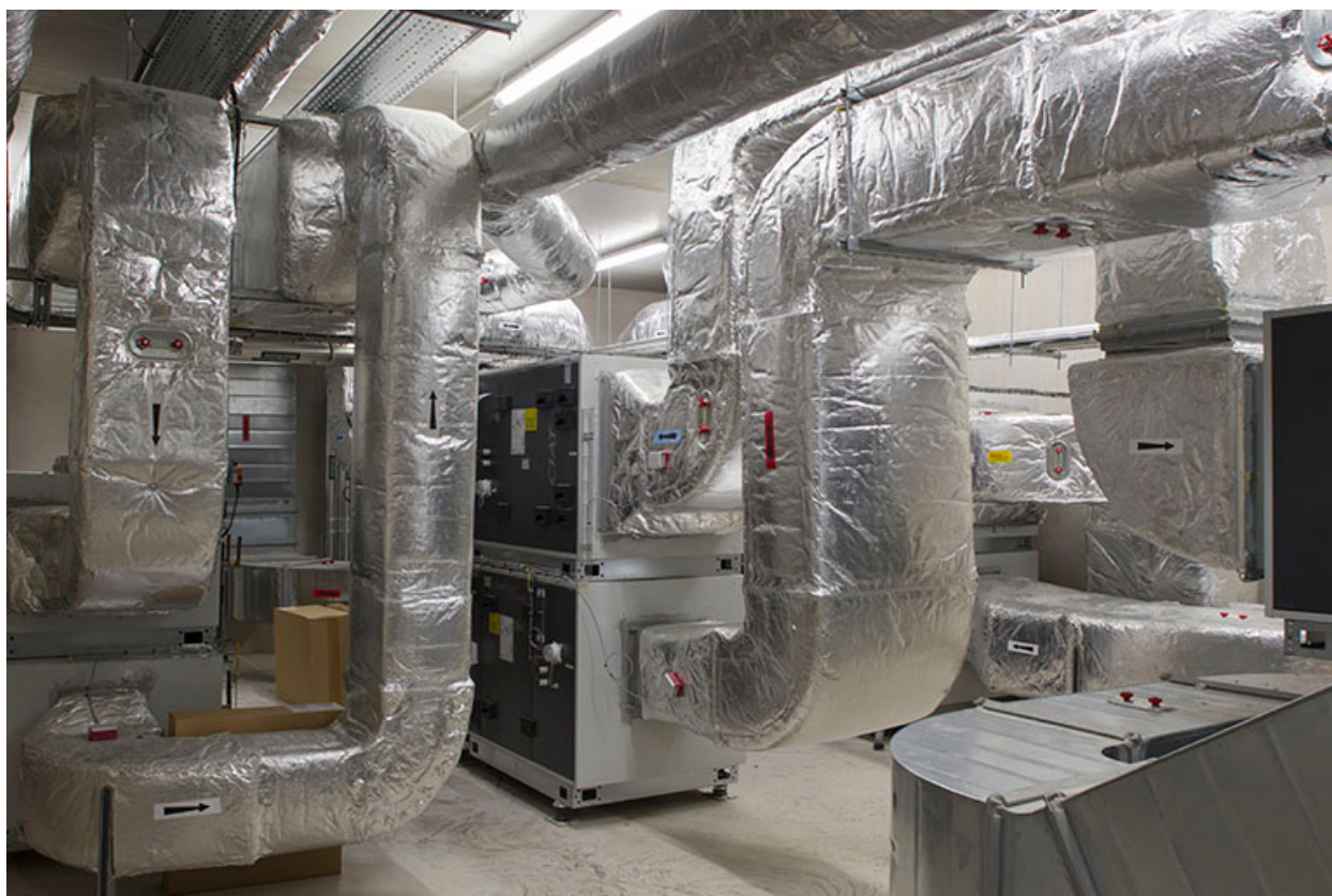
Machinerie d'extraction d'air du pôle hôtelier.
