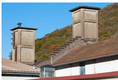
Anciens transformateurs électriques. Phot. Jérôme Mongreville IVR43_20142501613NUC4A
