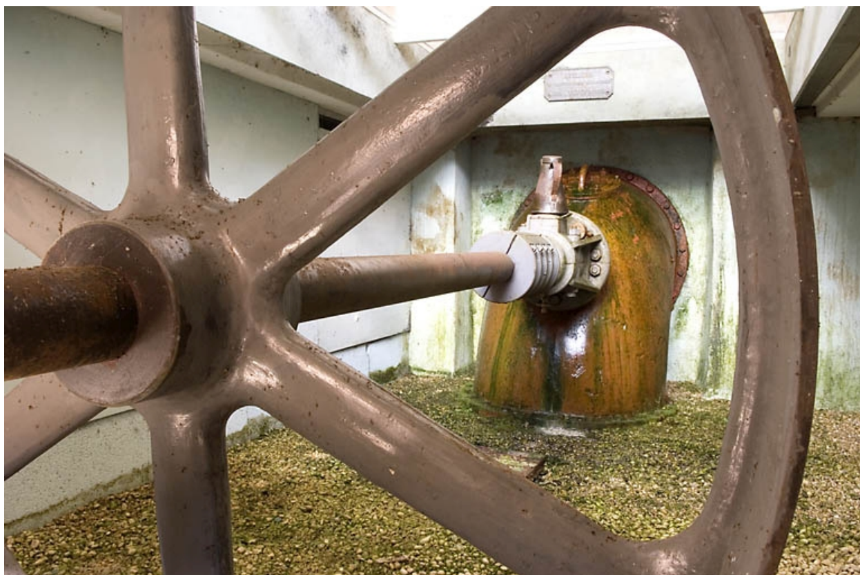
Usine : axe de transmission et volant.
