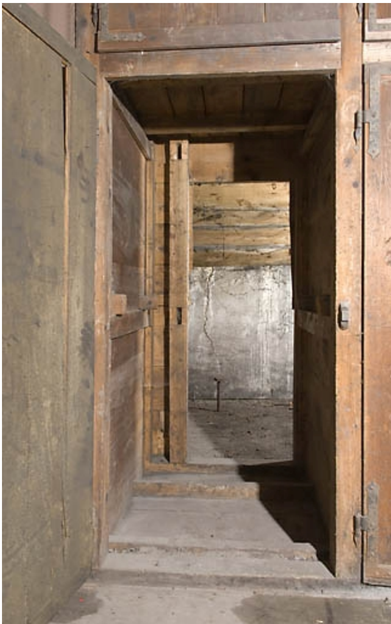
Usine, magasin industriel : placard ouvert.
