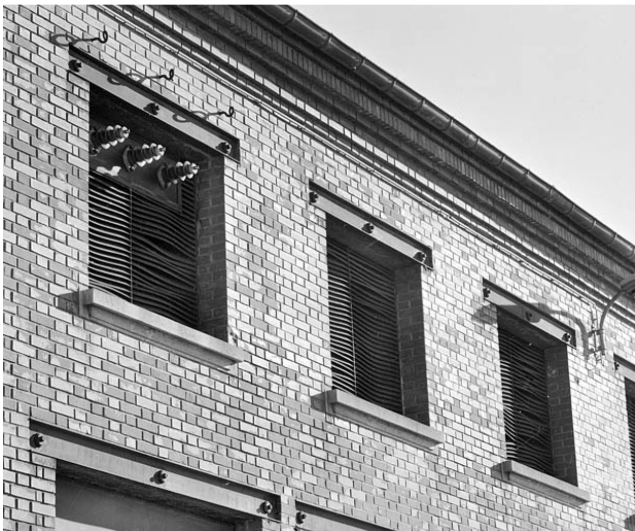
Transformateur : détail des baies supérieures.
