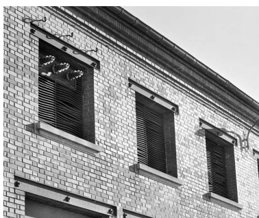
Transformateur : détail des baies supérieures. Phot. Jérôme Mongreville IVR43_20019000691X
