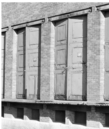
Transformateur : détail des portes métalliques. Phot. Jérôme Mongreville IVR43_20019000679X
