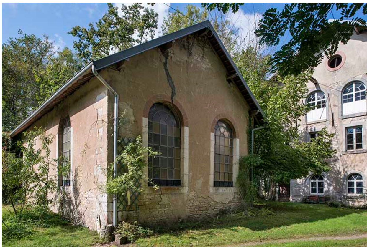
Salle de la machine à vapeur.
