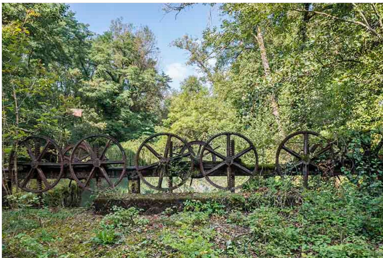
Mécanisme de levage du vannage (canal d'amenée).
